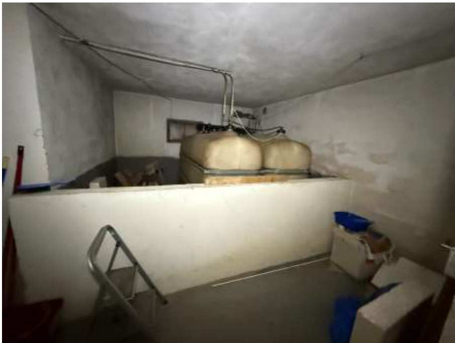
Bild 30: KG, Heizungsraum mit Öltank
