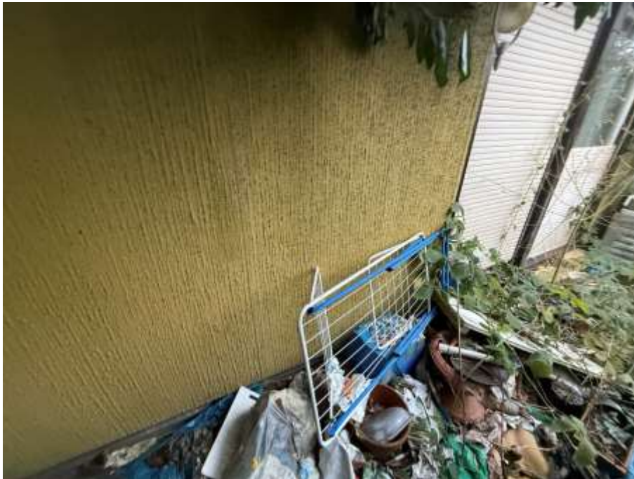
Bild 11: Detail Fassade (vermutlich mit Zementfaserplatten mit Asbestmaterial)
