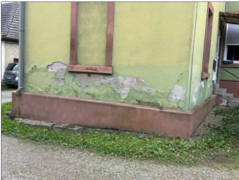
Bild 8: Detail Ostfassade, Feuchtigkeitsschäden
