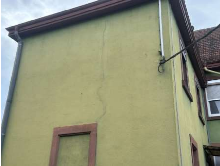
Bild 7: Detail Ostfassade, Riss
