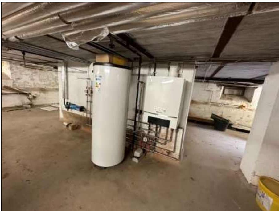
Bild 26: KG, Kellergeschoss, Gasheizung mit WW-Speicher
