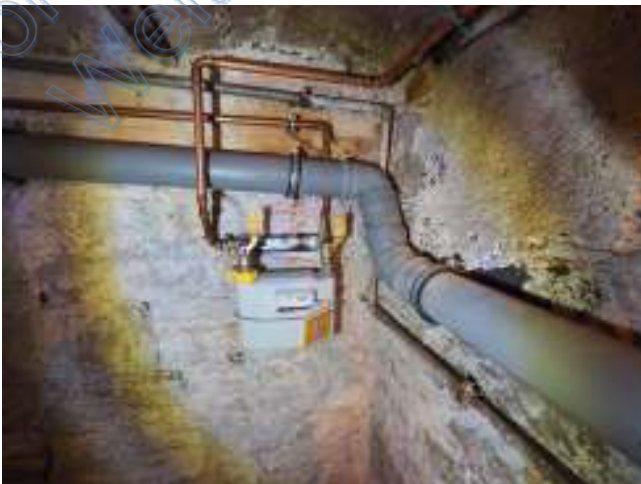
Gasanschluss im Untergeschoss
