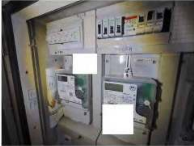
Sicherungskasten im Treppenhaus im Erdgeschoss
