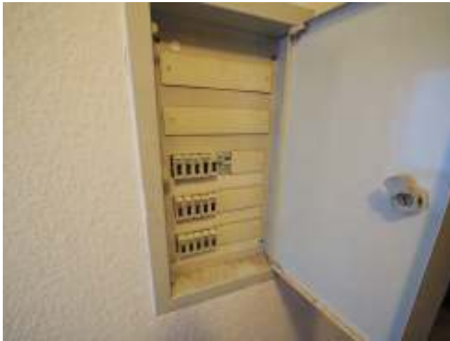
Sicherungskasten im Dachgeschoss
