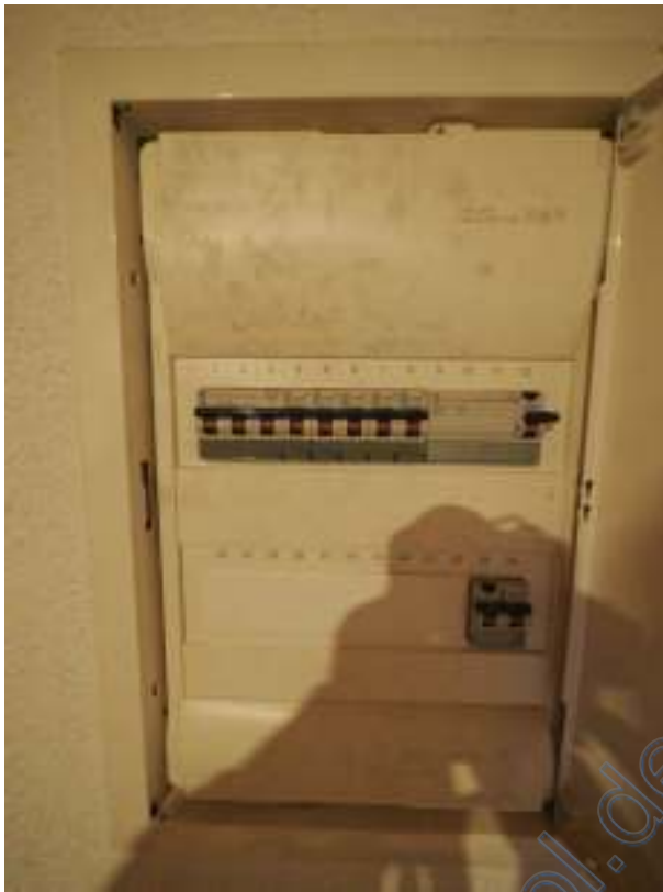
Sicherungskasten im Treppenhaus für die Wohneinheit 1. OG links
