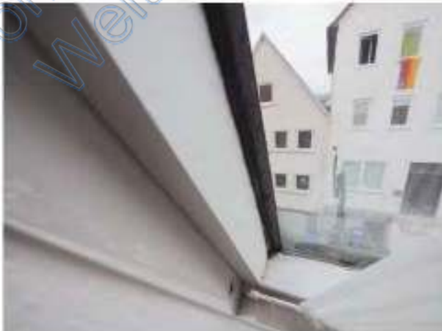
Veraltetes Dachflächenfenster im Dachgeschoss
