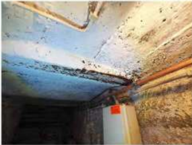
Korrodiertes Stahlträger der Kappendecke im Untergeschoss
