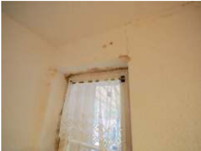
Wasserflecken in der Küche im 1. OG links
