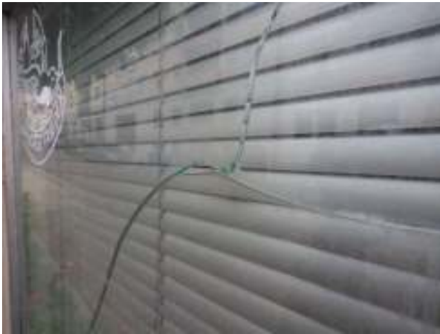
Beschädigung Schaufenster Gewerbeeinheit EG links
