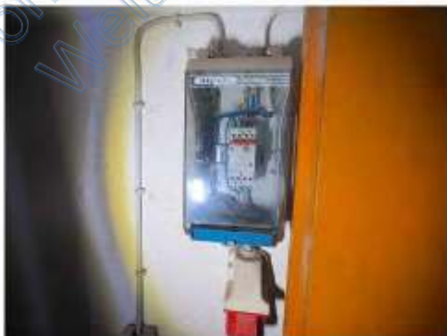
Starkstromanschluss im Abstellraum im Zwischengeschoss
