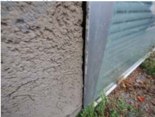
Ablösender Fensterrahmen Schaufenster Gewerbeeinheit EG links
