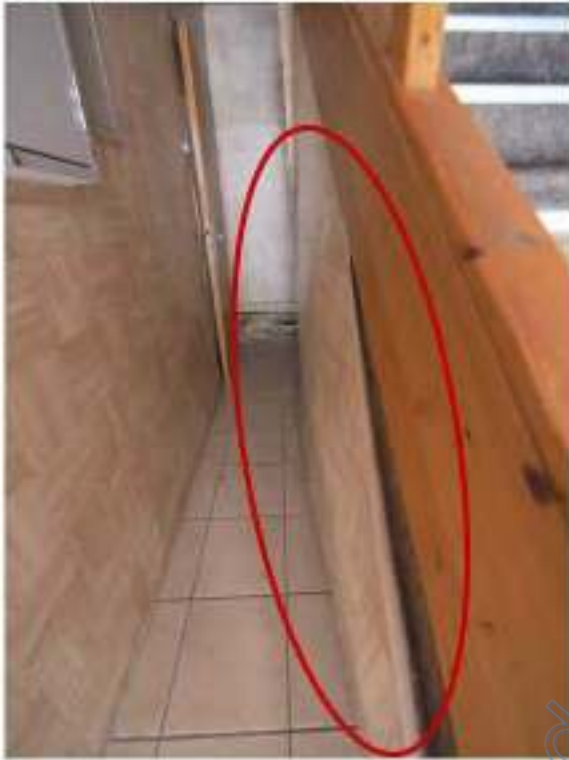
Auswölbung der Wand an der Treppe im Treppenhaus im Erdgeschoss
