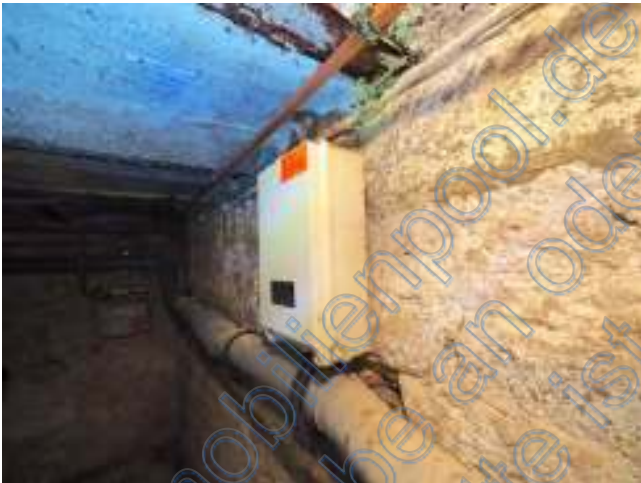
Stromanschluss Haus im Untergeschoss
