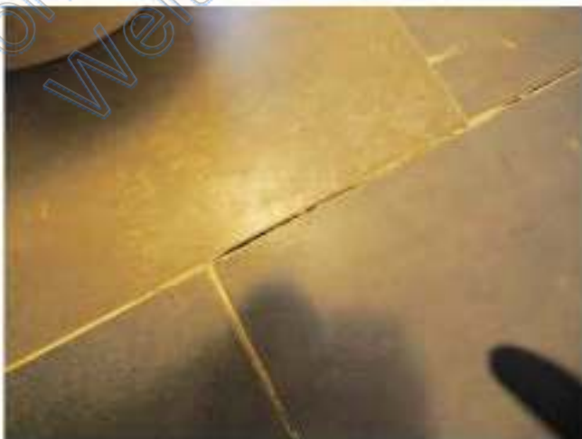
Fehlende Verfugungen im Bad im 1. OG rechts
