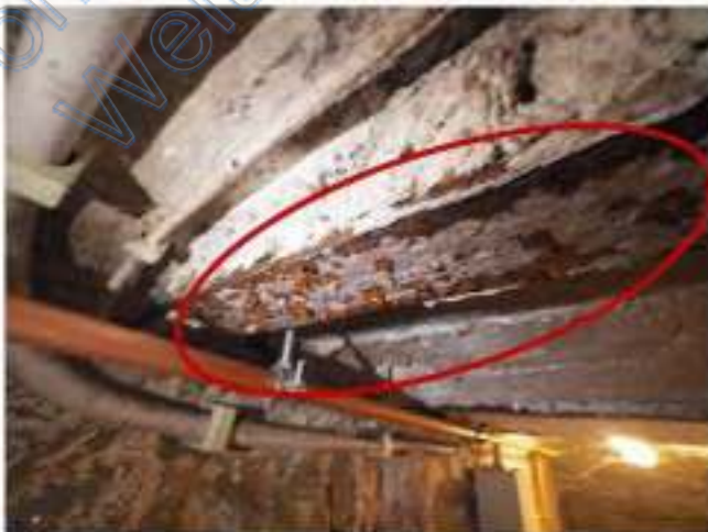
Wassertropfen auf dem Stahlträger der Kappendecke im Untergeschoss
