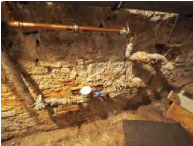
Wasseranschluss im Untergeschoss
