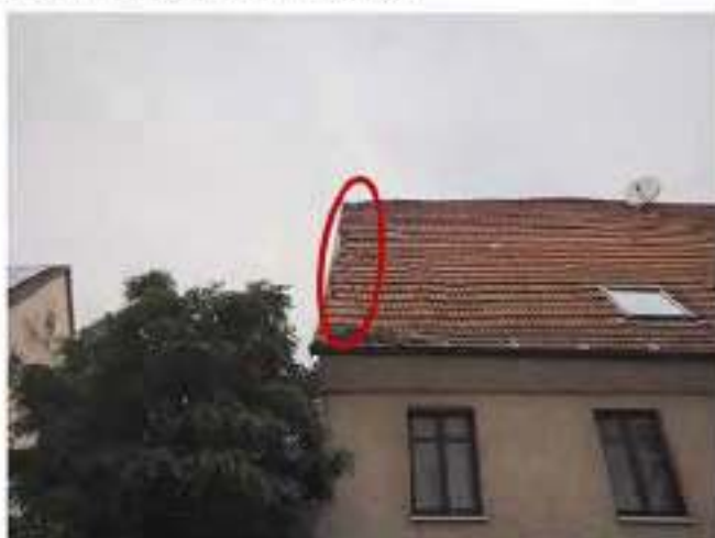
Fehlende Ziegel auf dem Dach
