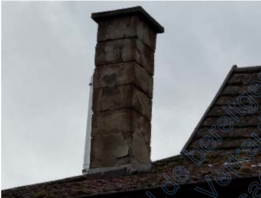
Kaminkopf mit Feuchteschaden und Putzabplatzungen
