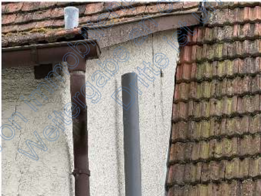
Bild 4 Dachdeckung überaltert – Undichtigkeiten vorhanden
