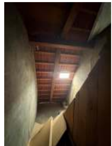
(46) Kein Zugang zum Spitzboden am Ortstermin möglich
