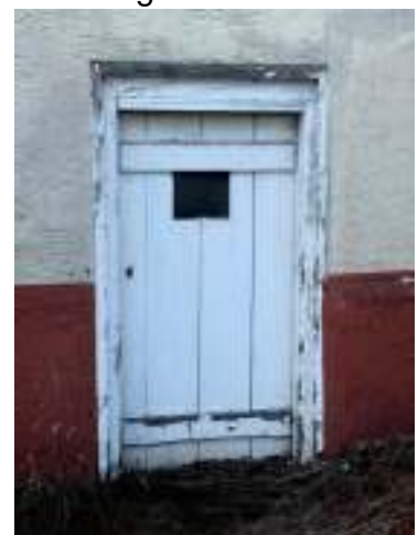
(64) Alle Außentüren müssen erneuert werden
