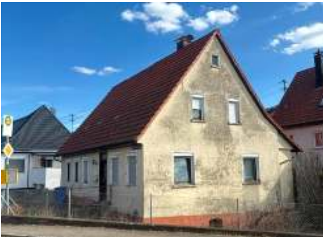
(57) Bauzustand Fassade, Risse Putzabplatzungen und Verfärbungen vorhanden; Fassade muss zwingend saniert werden
