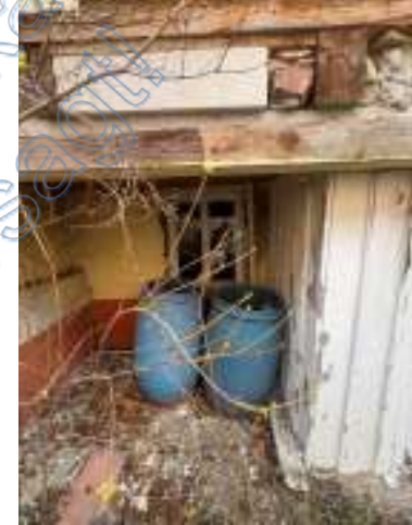
(61) Detail Südfassade / statische Überprüfung des Tragwerks erforderlich
