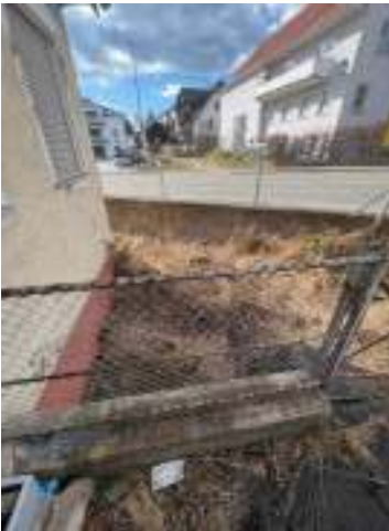
(53) Gartenzaun und Gartentor korrodiert
