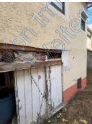
(62) Dito Südfassade / Holzbalkendecke in der Fassade offen Feuchtigkeit dringt ein
