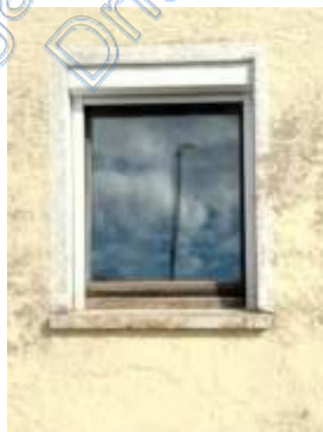
(63) Alle Fenster müssen erneuert werden
