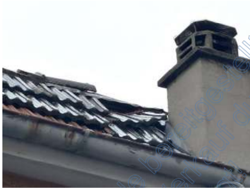
Bild 5: Detail, beschädigtes Dach
