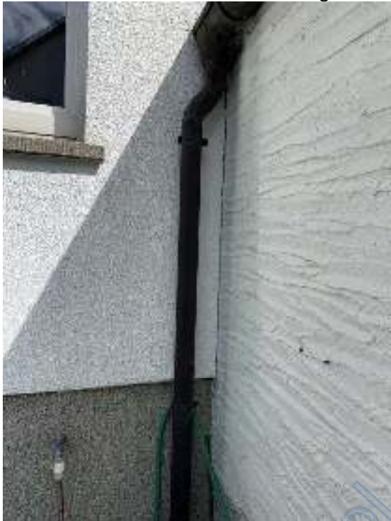
Bild 7 und Bild 8 Wandriss Zwischenbau Wohnhaus - Garage
