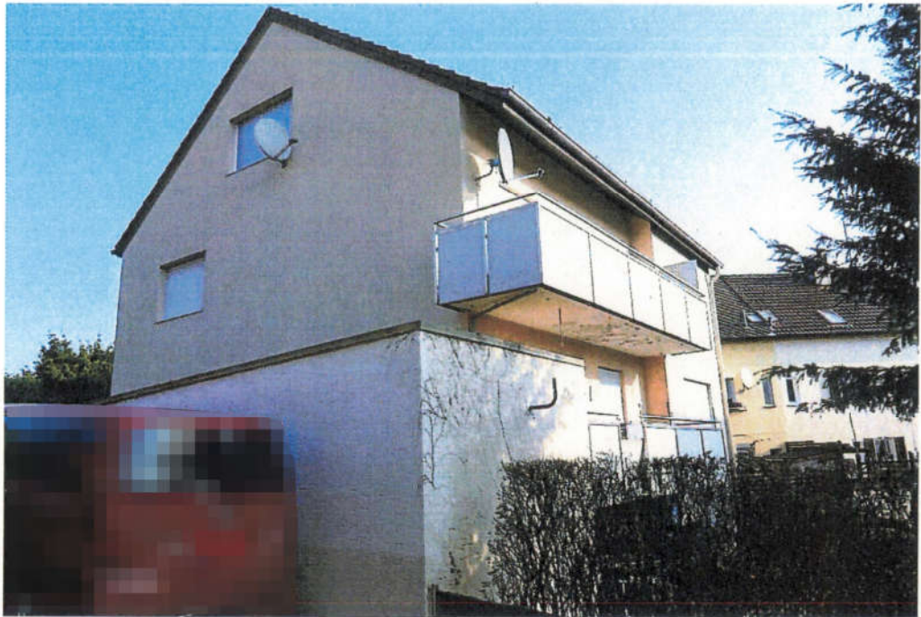
Ansicht des Mehrfamilienwohnhauses von Süden. An der Balkonunterseite der Wohnung im Obergeschoss sind Farb- und Putzabplatzungen sichtbar.
