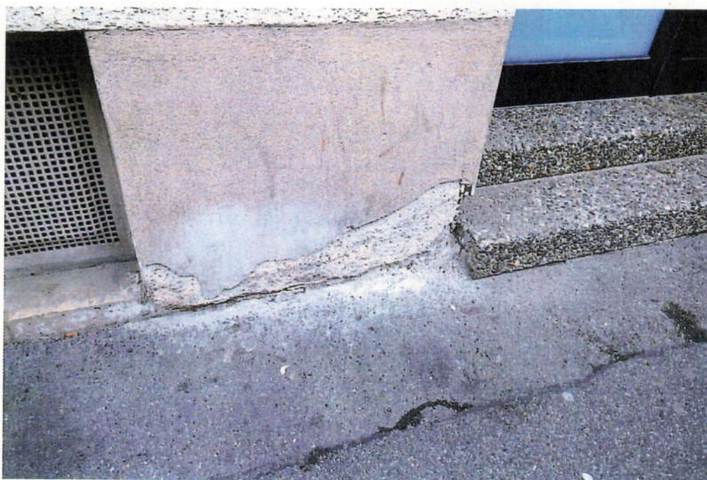
An der Außenfassade sind einige Farb- und Putzabplatzungen vorhanden.
