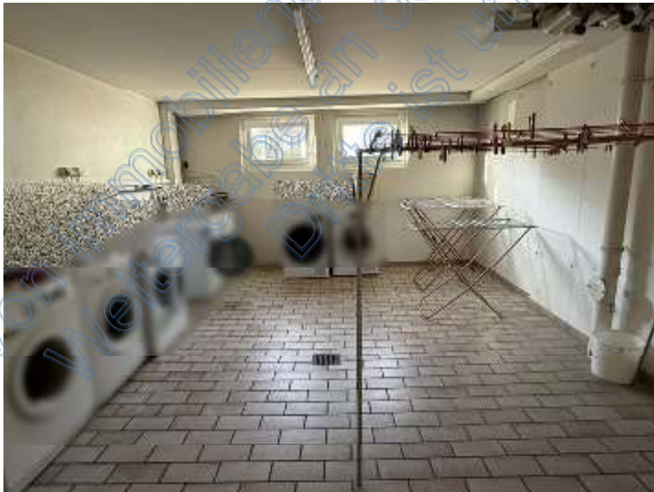
Bild 6 Wasch- und Trockenraum im Untergeschoss
