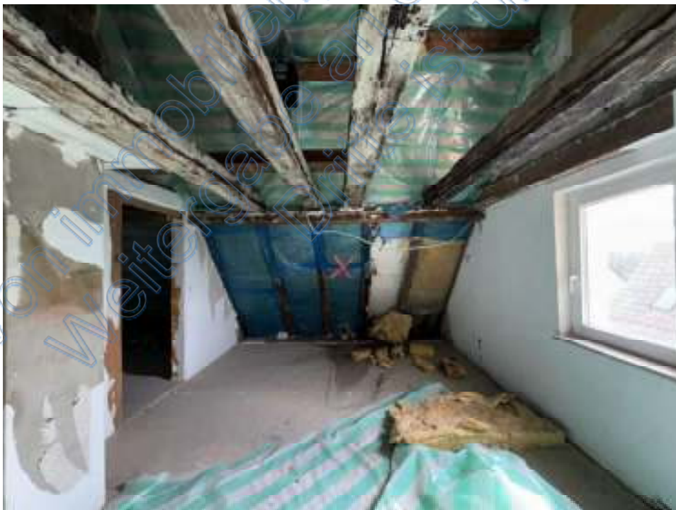
Bild 22 Nicht ausgebautes Dachgeschoss – rechte Bildseite entfernte Dämmung nach Wassereinbruch
