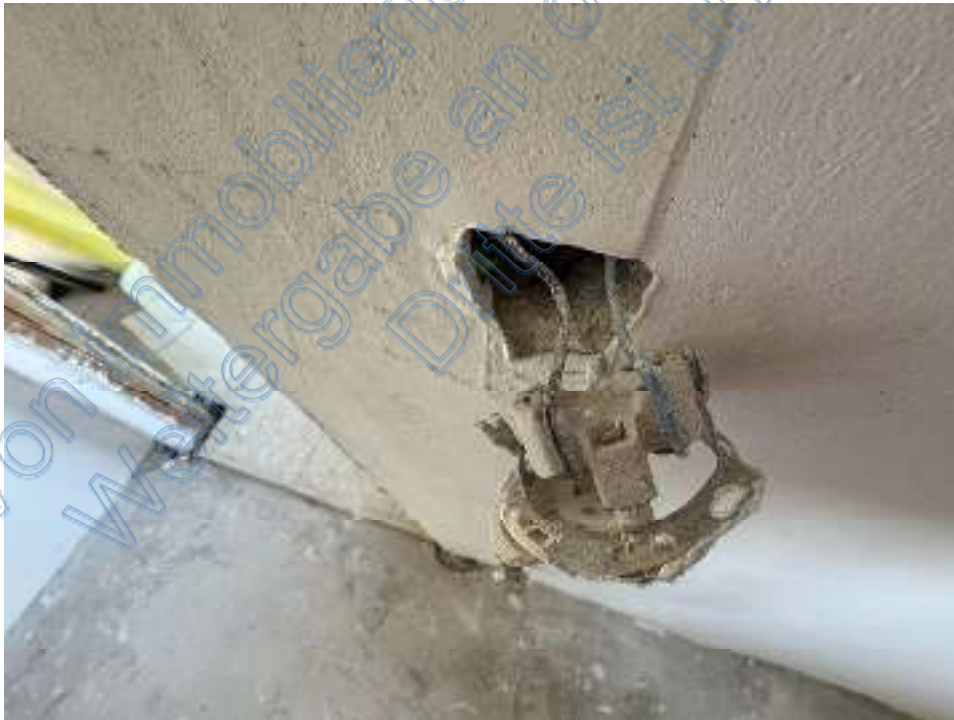
Bild 12 Erdgeschoss – zweiadrige Installation
