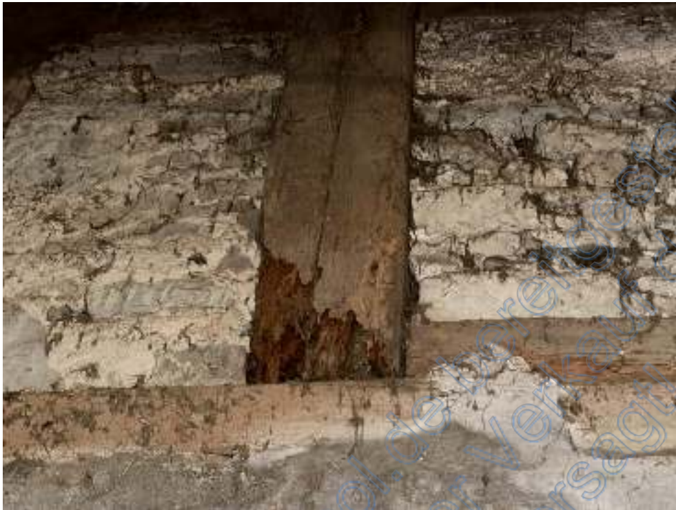
Bild 13 Erdgeschoss – Ökonomieteil mit schadhaftem Balken
