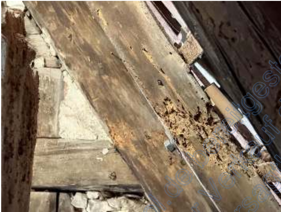
Bild 21 Dachspitz - Fraßspuren Holzschädlinge
