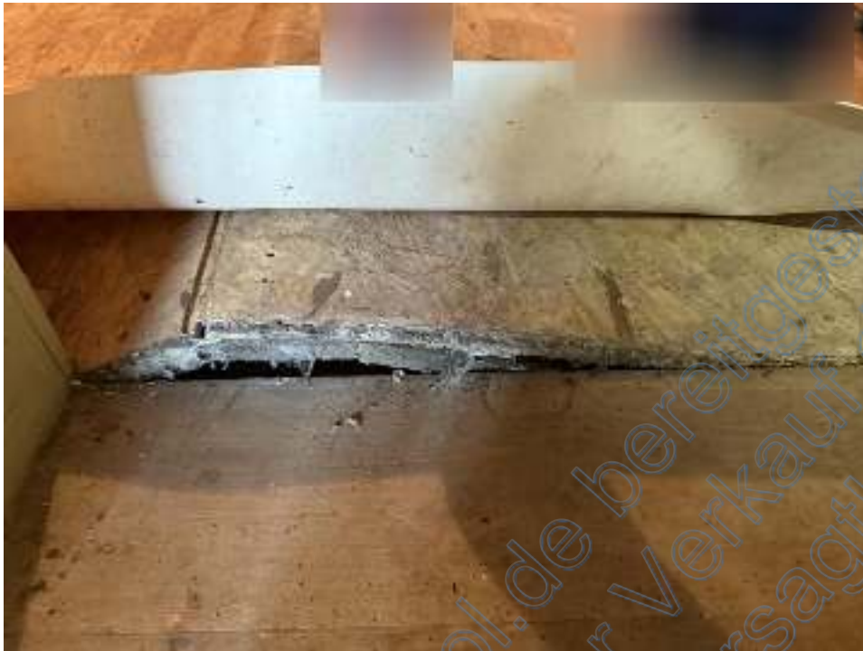
Bild 9 Erdgeschoss – aufgequollener Boden
