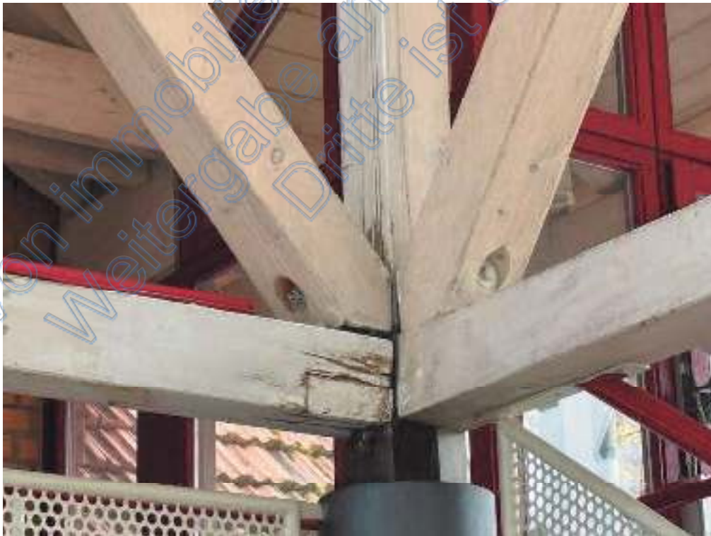
Dachgeschoss – Feuchteschaden an Holzkonstruktion
