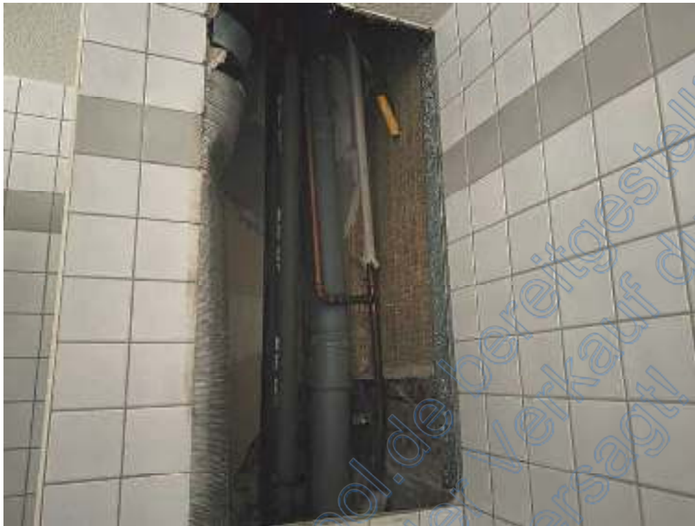
Obergeschoss – Sanitärbereich nach Angabe außer Betrieb
