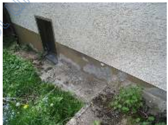
Reparaturstau Putzabplatzungen am Sockel
