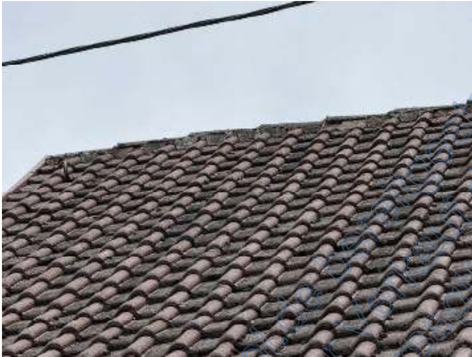
First mit fehlendem Firstziegel
