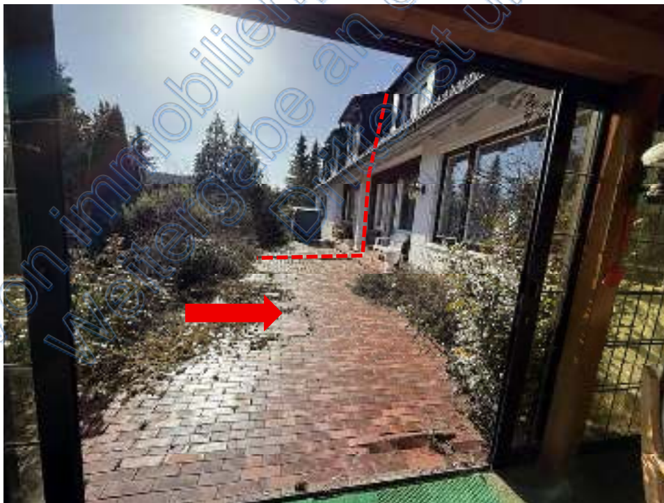
Erdgeschoss – Terrasse mit Fliesenschäden
