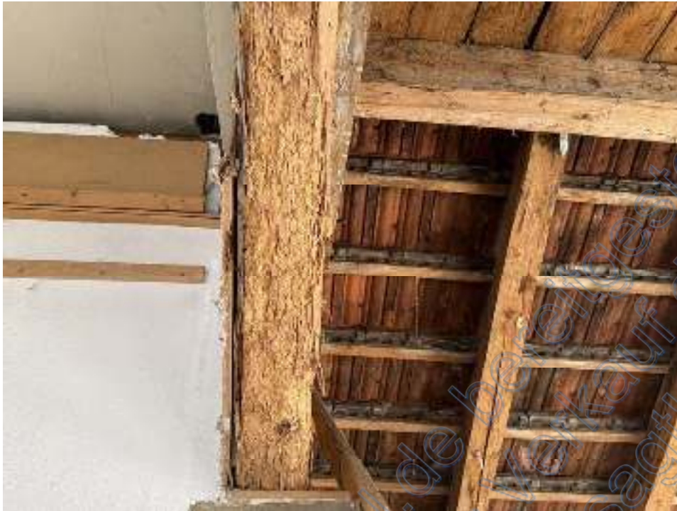
Bild 25 Nagekäferbefall an Holzbalken
