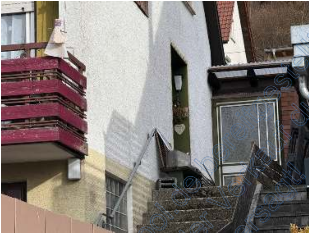
Bild 3 Uhlandstraße 56 – Eingang Erdgeschoss mit nicht genehmigtem Anbau
