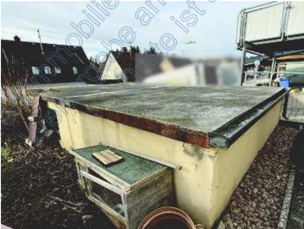
Bild 8 Uhlandstraße 58 – Garage, Schäden an Flachdach und Fassade
