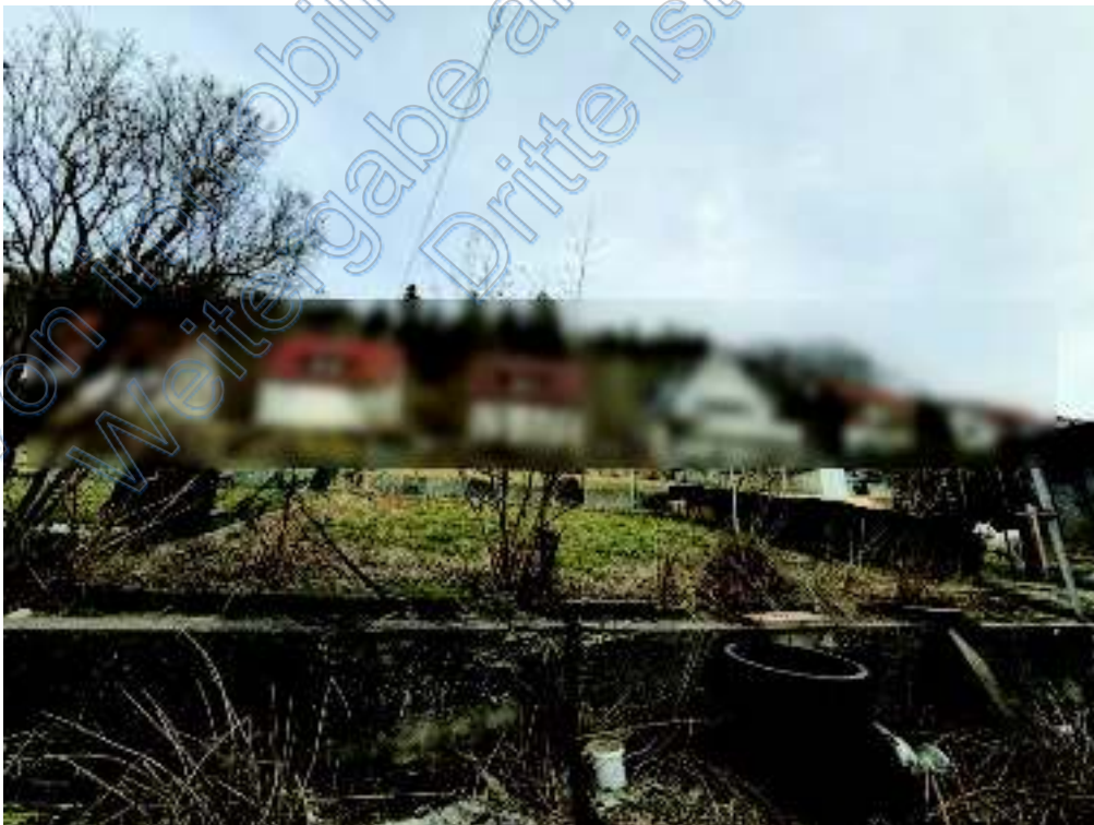
Bild 6 Uhlandstraße 58 – Schäden an der Gartenmauer
