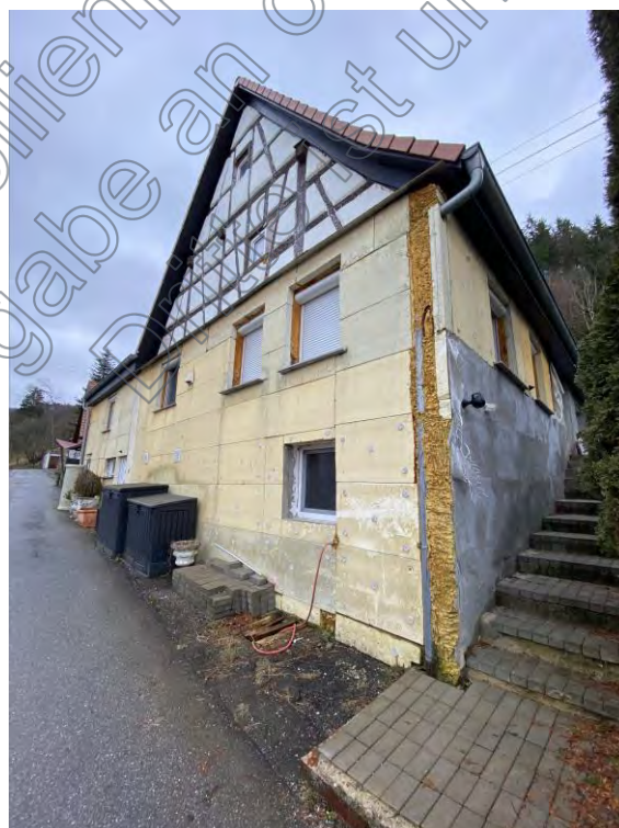
Bild 8: Mangelhafte Anbringung der Dämmplatten
