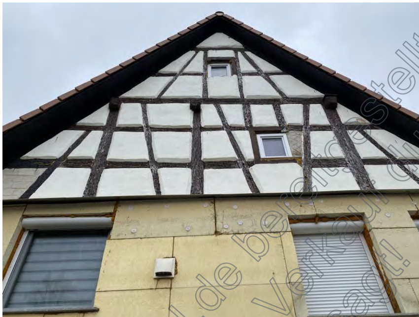
Bild 9: Holzfachwerk, tlw. mit Bauschaum ausgefügt, Gebälk tlw. Feuchtigkeitsschäden, angefault
