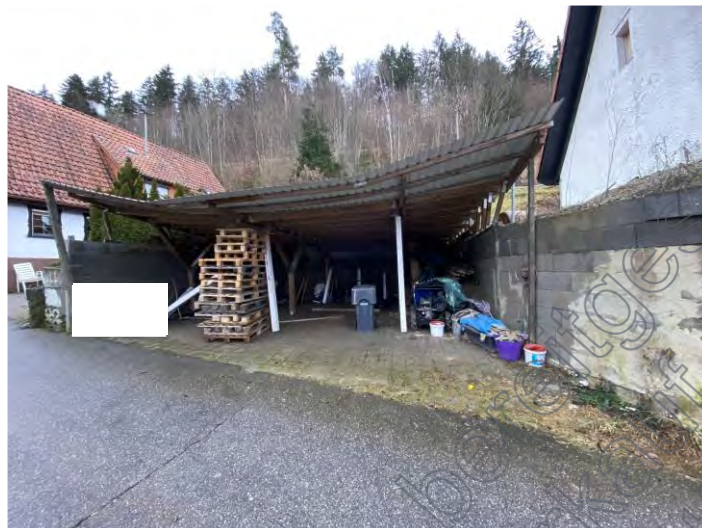
Bild 7: Stellplatz, überdacht mit Trapezblech, Gefahr eines Einsturzes
