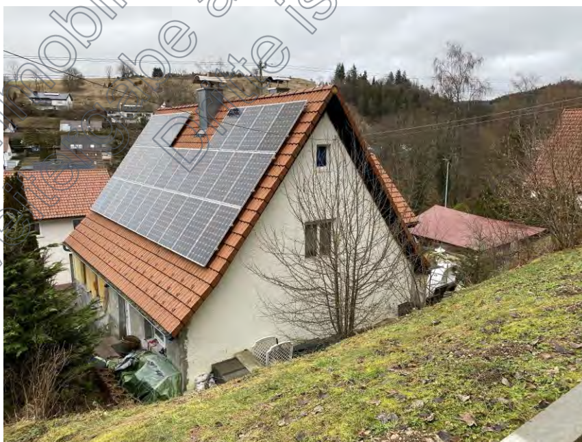
Bild 10: PV-Anlage an der Westseite
