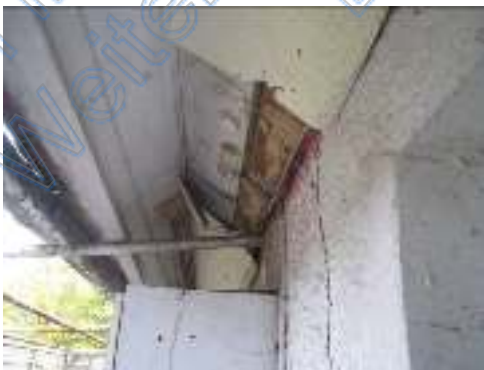
Wasserschaden/Riss oberhalb Balkon
