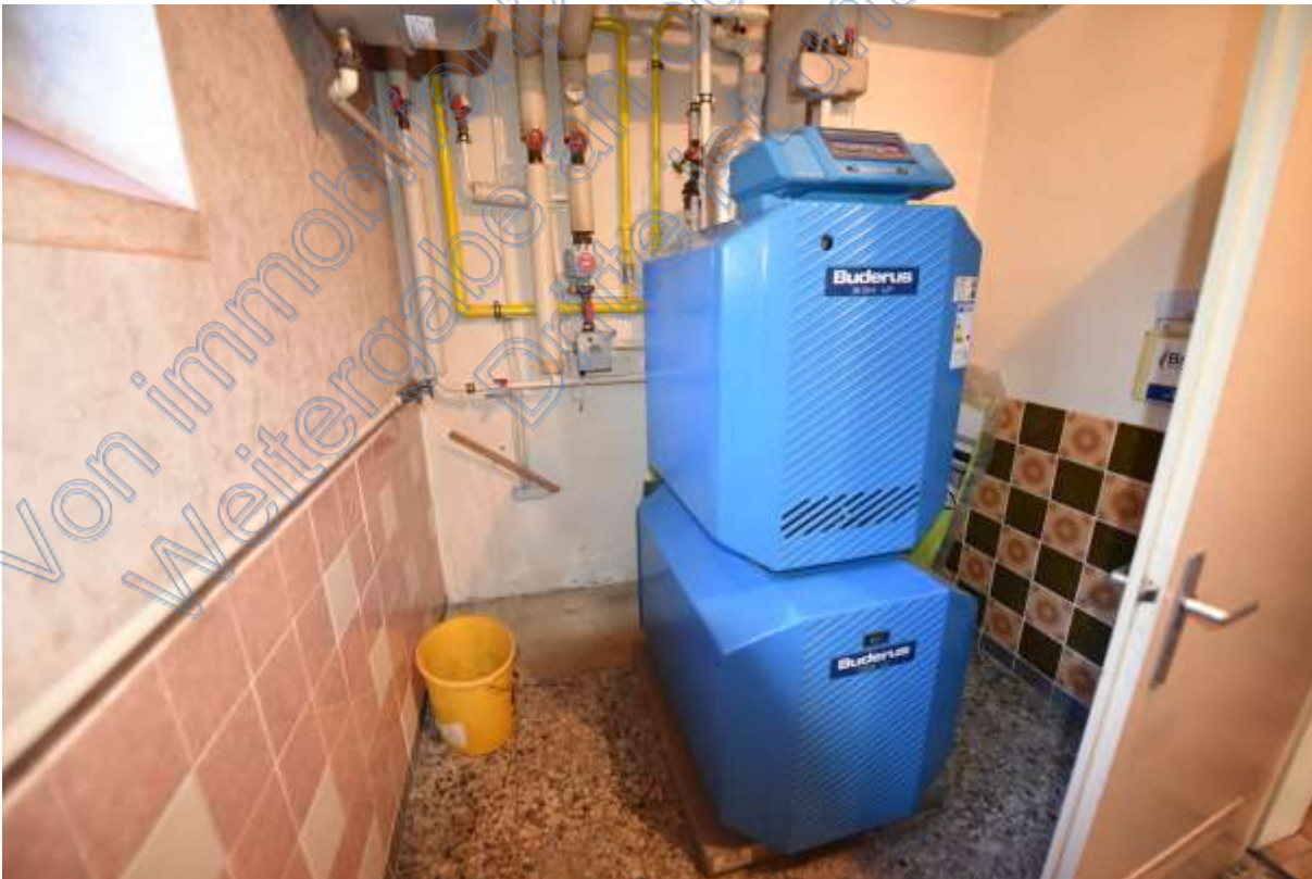
Abb. 53 Kellergeschoss. Heizungsraum, Heizung
