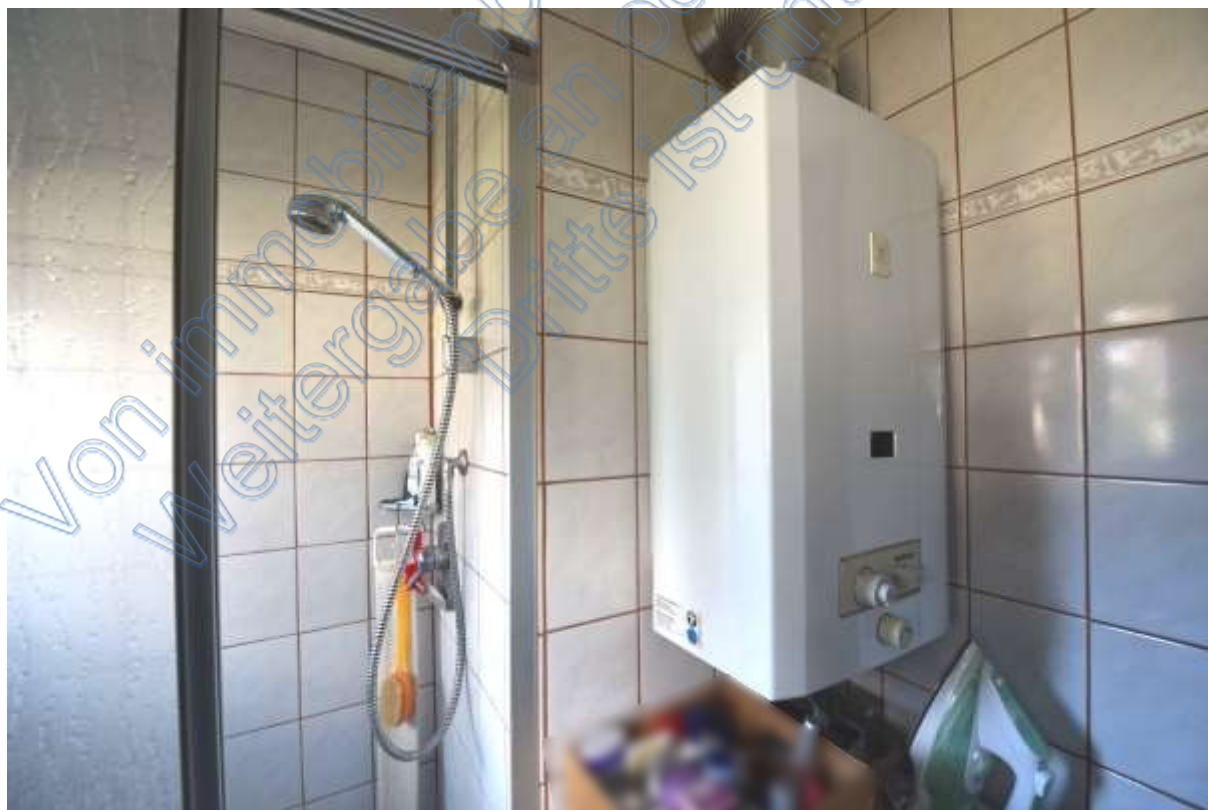
Abb. 89 Dachgeschoss. Bad, Dusche, Gastherme
