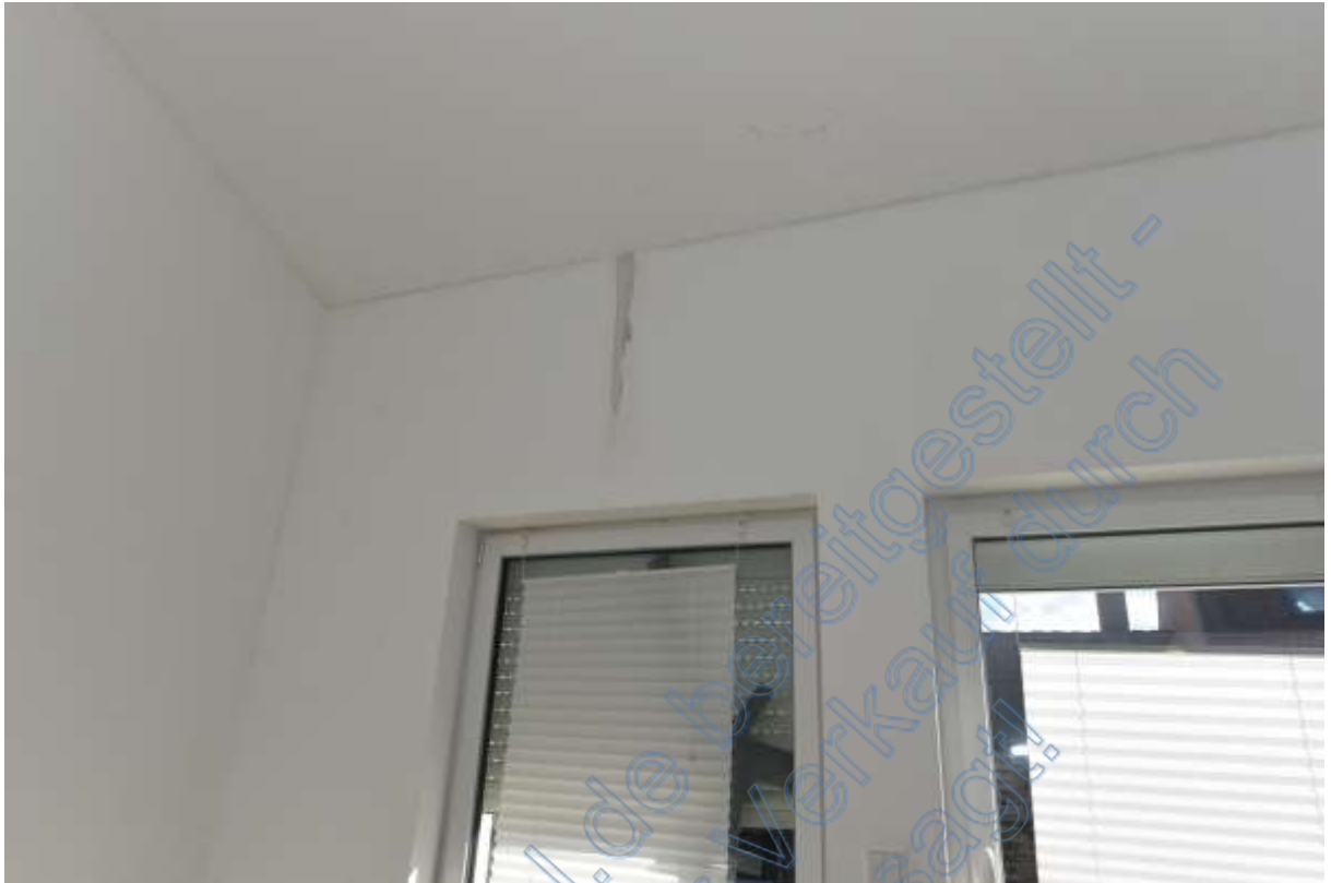
Abb. 148 Haus Nr. 1a. Dachgeschoss links, Wohnung Nr. 1. Feuchtigkeitsschaden
