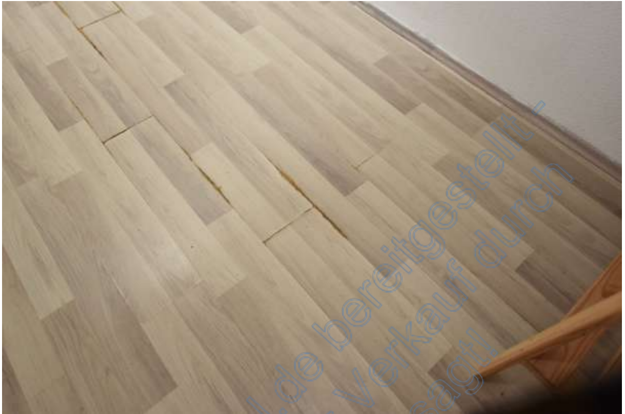
Abb. 176 Haus Nr. 3. Obergeschoss. Wohnung 2. Flur, beschädigtes Laminat
