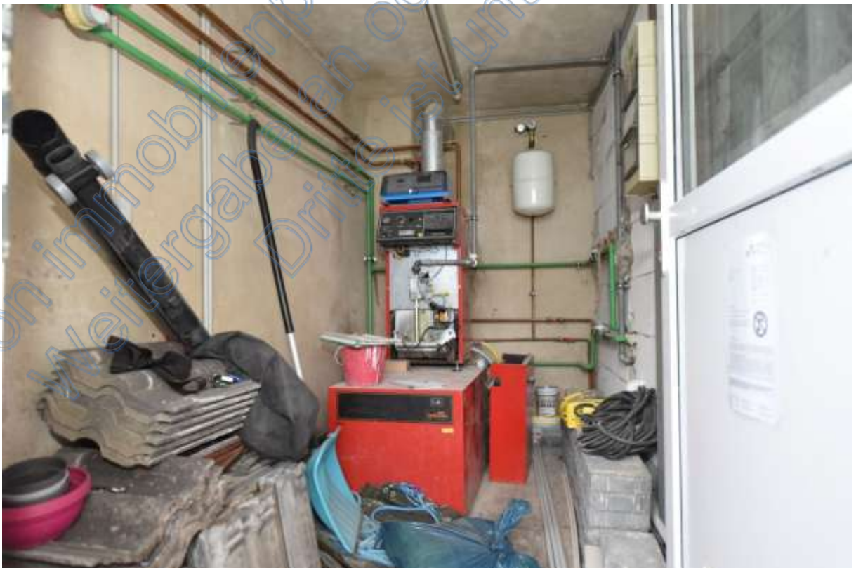
Abb. 197 Haus Nr. 3. Erdgeschoss. Hof. Heizungsraum
