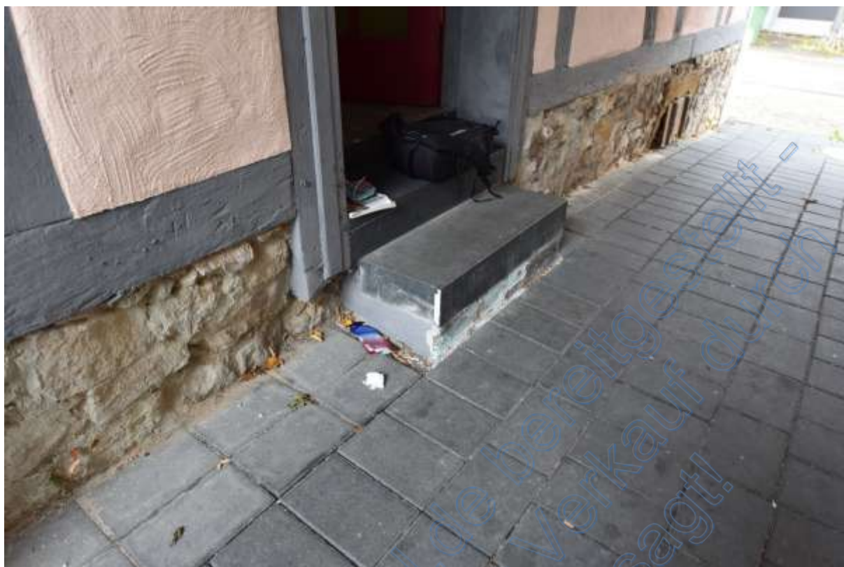
Abb. 194 Hof. Baumängel Durchgang. Eingangsstufen
