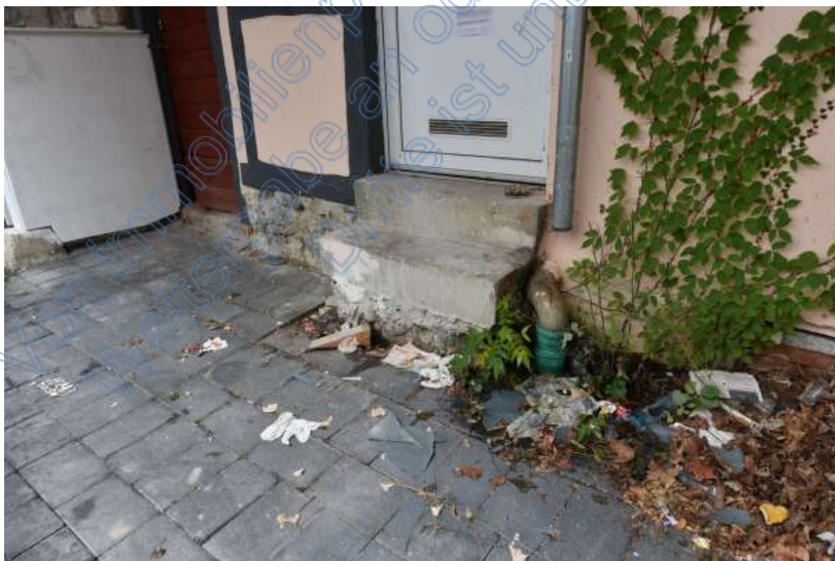
Abb. 195 Hof. Baumängel Eingangsstufen
