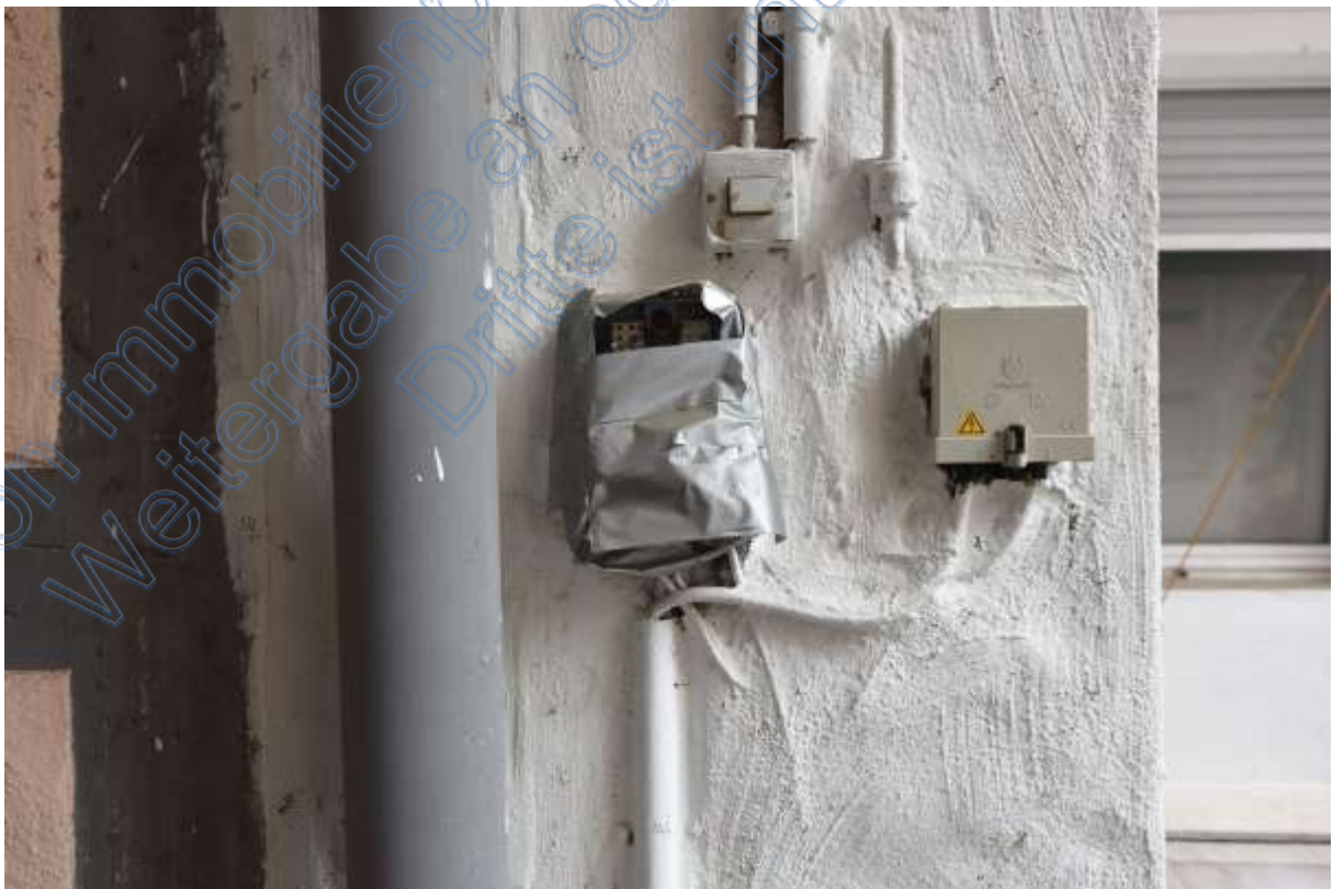
Abb. 193 Hof. Baumängel Elektrik
