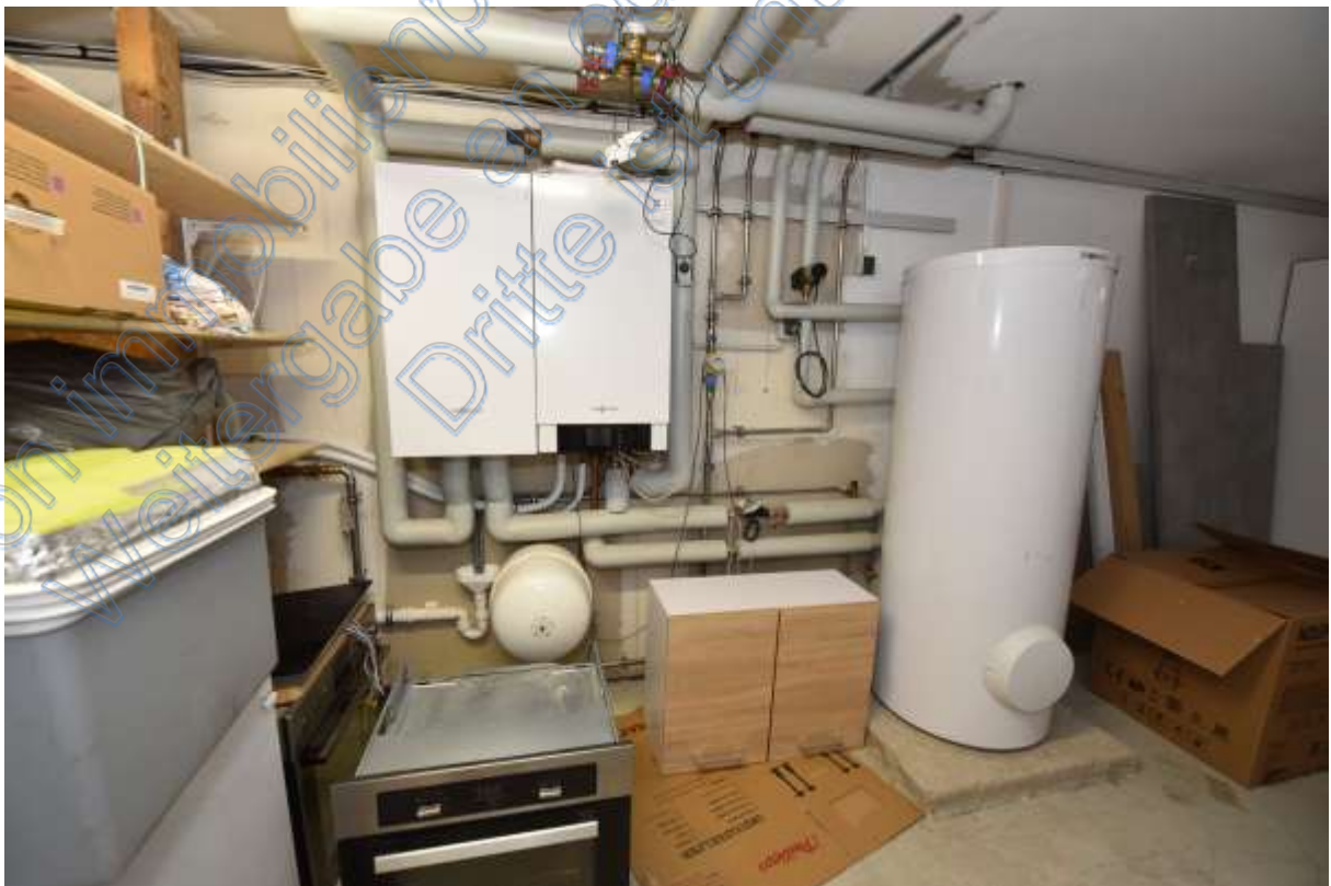
Abb. 105 Haus Nr. 1a. Erdgeschoss. Heizungsraum
