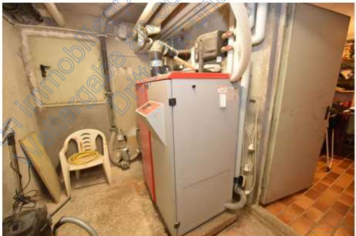
Abb. 106 Kellergeschoss. Heizungsraum, Heizung
