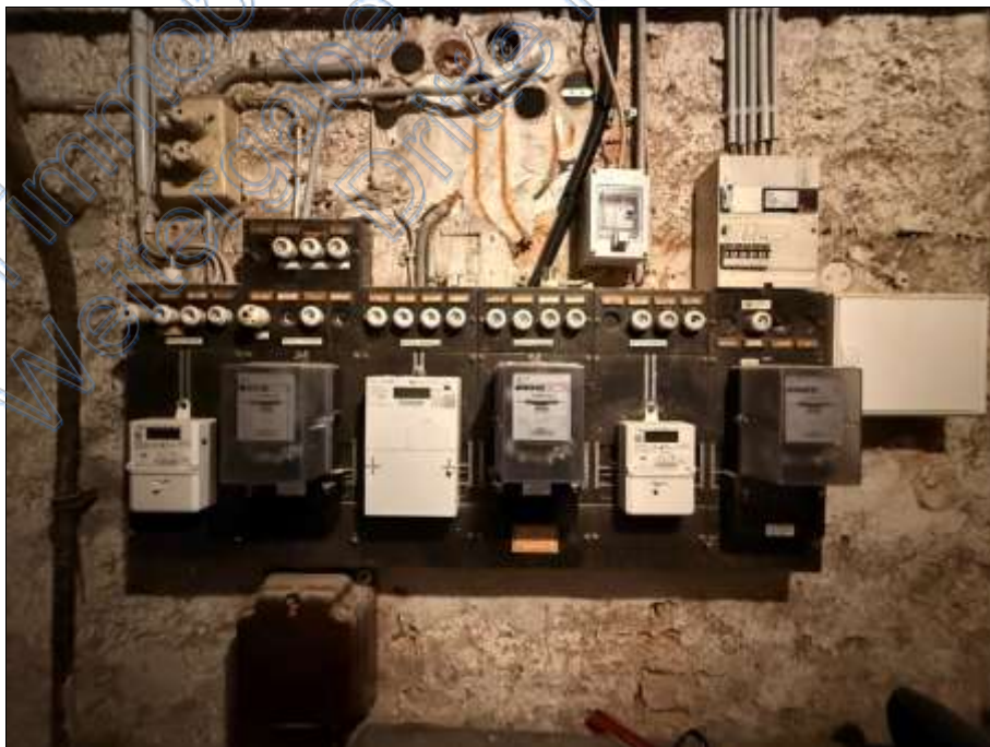
Bild 44: KG, Detail - Elektroinstallation
