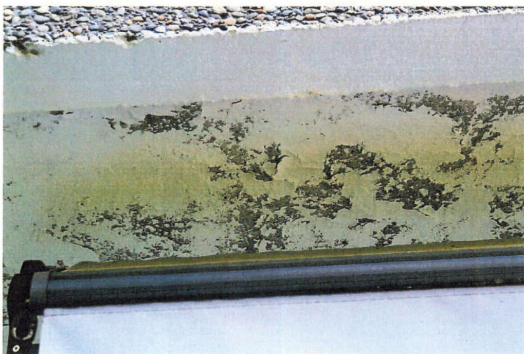
An der Balkonunterseite sind Farb- und Putzabplatzungen vorhanden.
