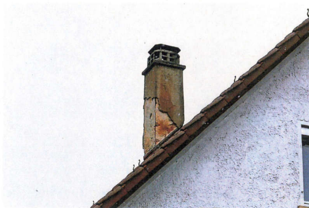
Der Schornsteinkopf bedarf einer Sanierung bzw. Erneuerung.
