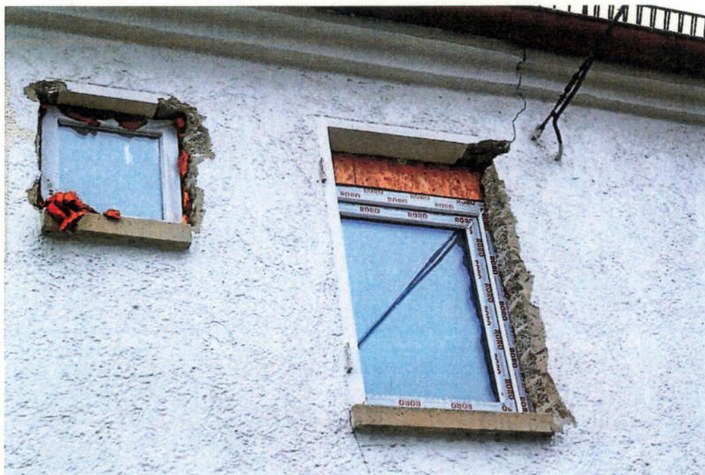
Im Zuge der Erneuerung der Fenster wurde das Mauerwerk beschädigt. Ferner ist ein größerer Riss sichtbar.
