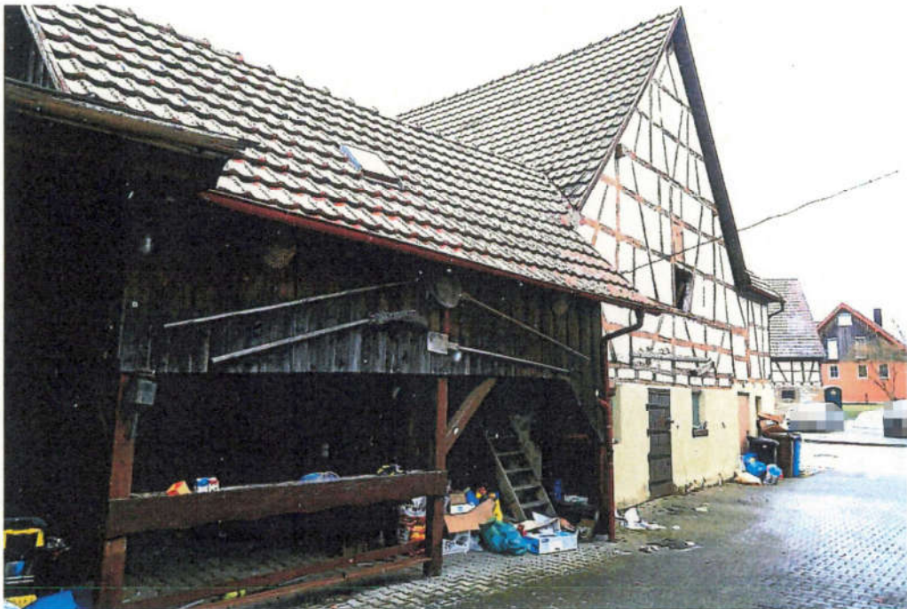
Blick auf das Schuppengebäude nebst Scheune von Südwesten. An der Fassade des Scheunengebäudes sind teilweise Putzabplatzungen, im unteren südlichen Fassadenbereich ist Feuchtigkeit sichtbar. Auf der südlichen Gebäudeseite fehlt ein Teil der Ausmauerung.
