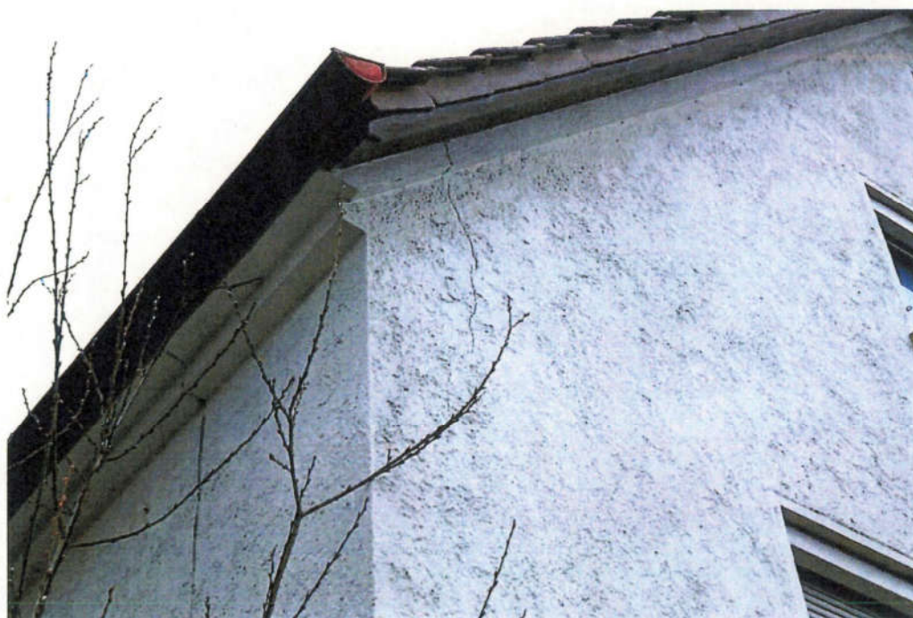
An der Fassade des Doppelwohnhauses sind neben Farb- und Putzabplatzungen auch vereinzelt Rissbildungen sichtbar.
