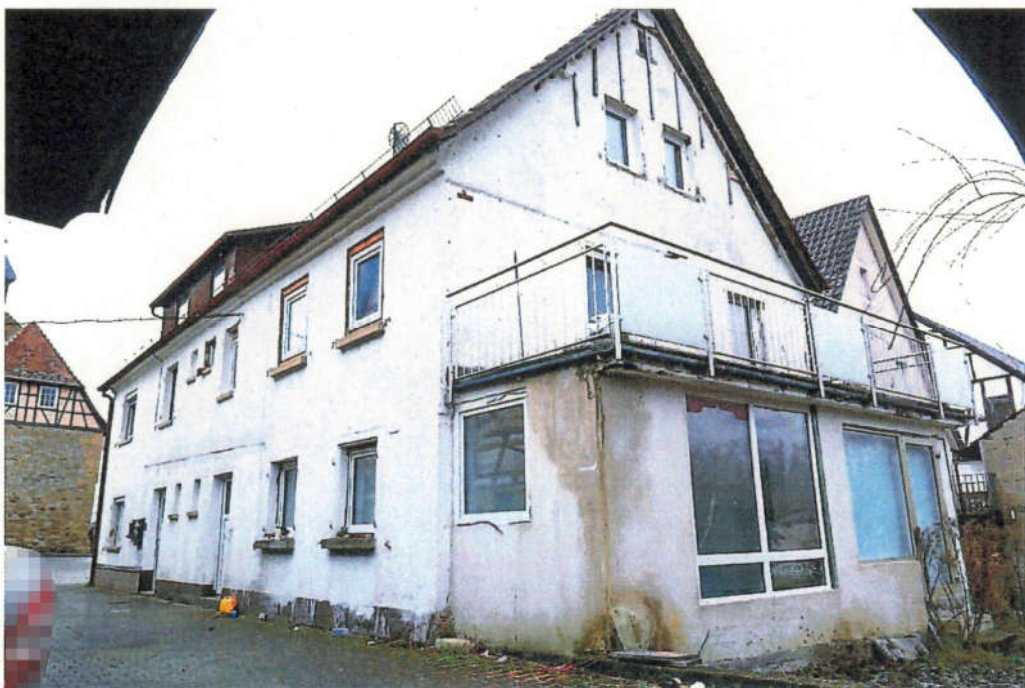
An dem angebauten Wintergarten mit Balkon sind deutliche Feuchtigkeitsspuren sichtbar.
