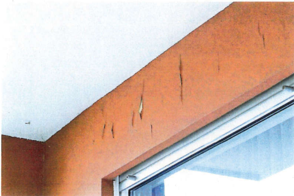
An der Hausfassade sind vereinzelt Farb- und Putzabplatzungen vorhanden.
