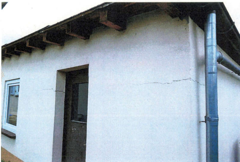
An der Fassade der Garage nebst angrenzendem Geräteraum sind Rissbildungen sichtbar.
