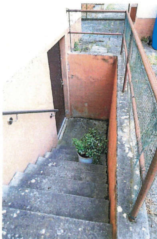
Blick auf die Kelleraußentreppe. An der Fassade sind Feuchtigkeitsspuren vorhanden.
