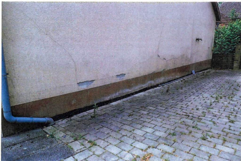
An der nordwestlichen Gebäudeseite sind Feuchtigkeitsschäden mit Farb- und Putzabplatzungen sowie Rissbildungen sichtbar.
