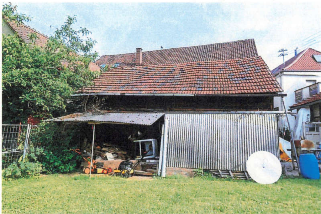
Seitenansicht des freistehenden Schuppengebäudes. Dieses befindet sich in einem abbruchreifen Zustand.
