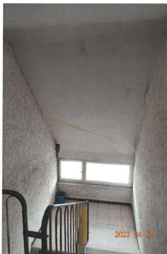
Treppenhaus (Wasserschaden) im DG
