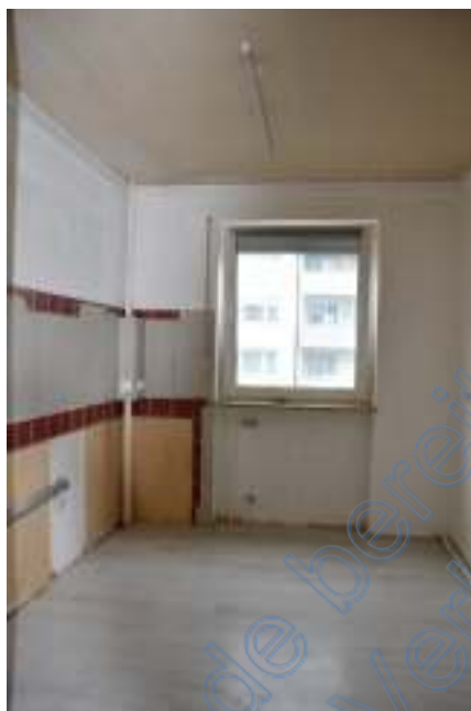
Bild 15: 1. Obergeschoss Küche, Heizkörper fehlt
