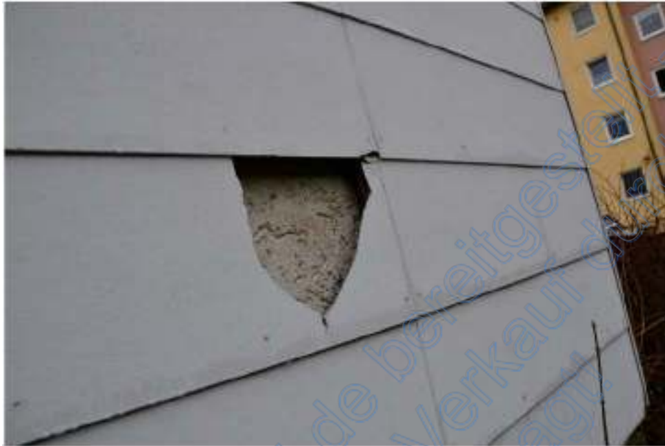
Bild 9: Schäden an der Verkleidung des Westgiebels
