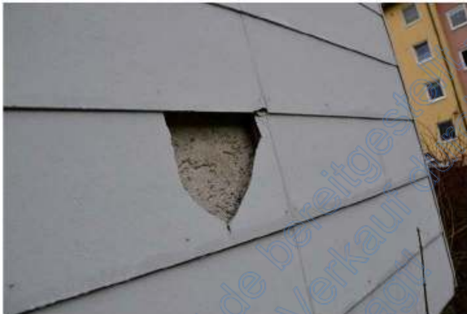
Bild 9: Schäden an der Verkleidung des Westgiebels
