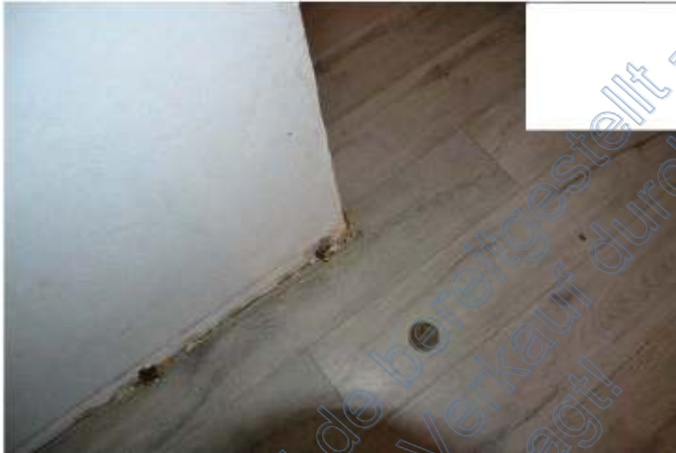
Bild 23: 1. Obergeschoss Flur, Trocknungslöcher, fehlende Sockelleisten
