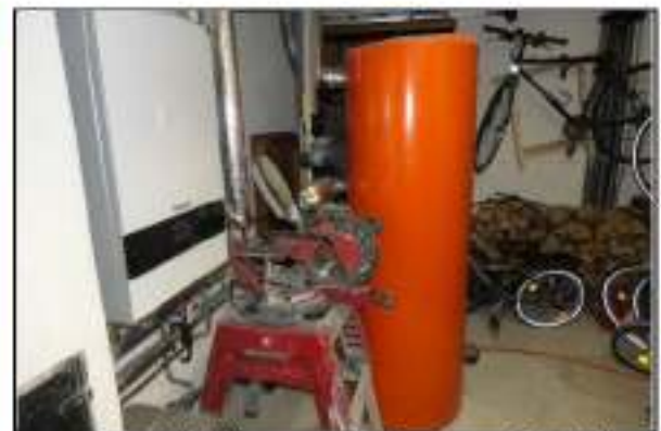
Gem. Abstellraum mit Therme und Speicher
