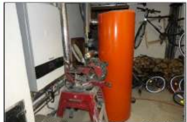
Gem. Abstellraum mit Therme und Speicher
