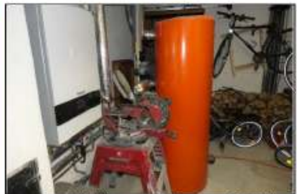
Gem. Abstellraum mit Therme und Speicher
