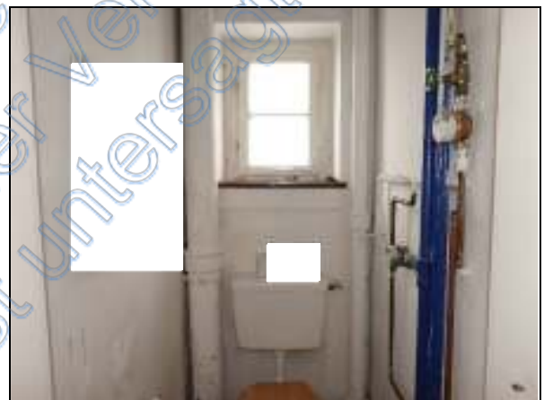
Whg. EG rechts WC, AP-Install.
