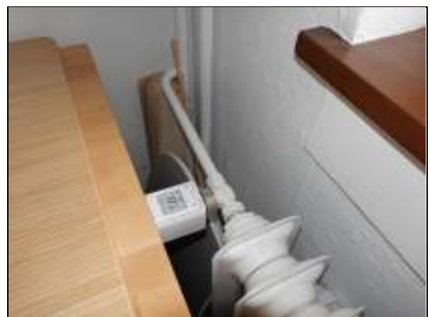
Heizkörper AP-Install., Beispiel
