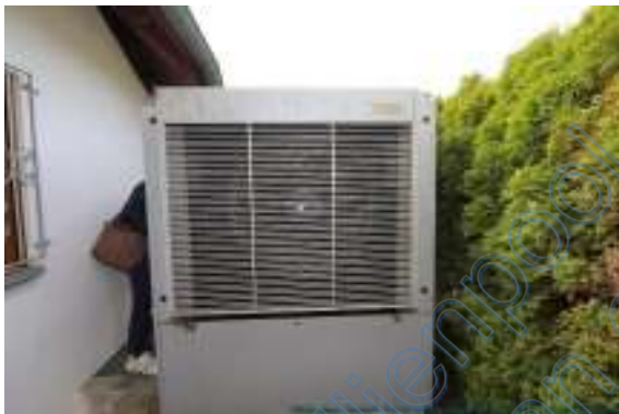
Aggregat der Wärmepumpe Fa. Weishaupt
