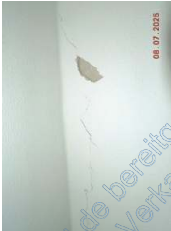
Bild 5: Schäden im Treppenhaus
