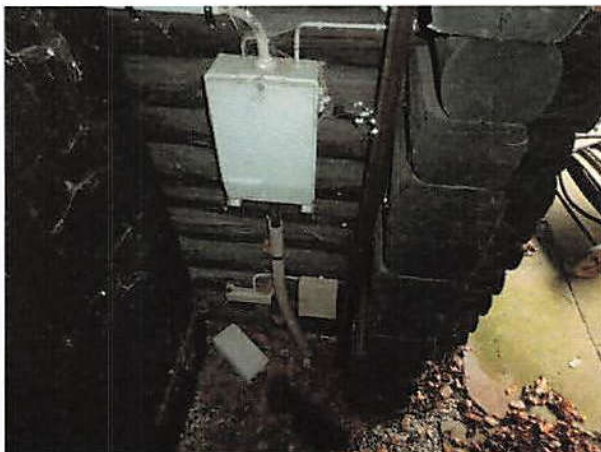
Stromanschluss | Strom abgestellt
