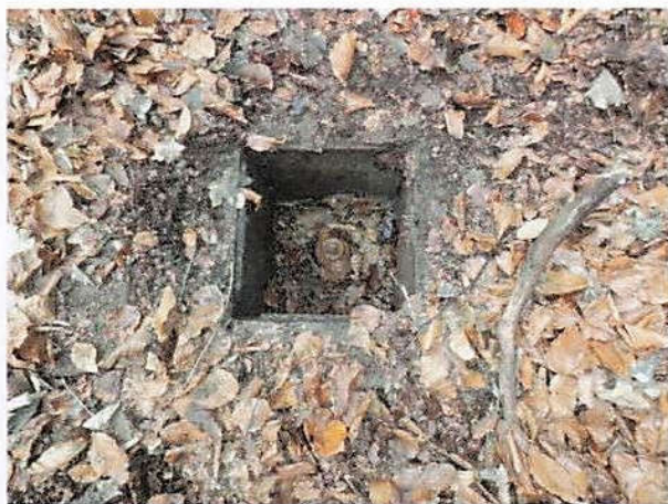
Stauventil im Boden eingelassen
