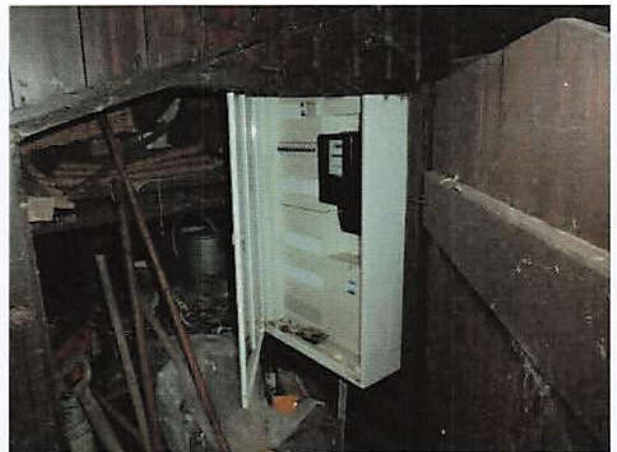
Sicherungskasten aus 1995 und Hauptzähler
