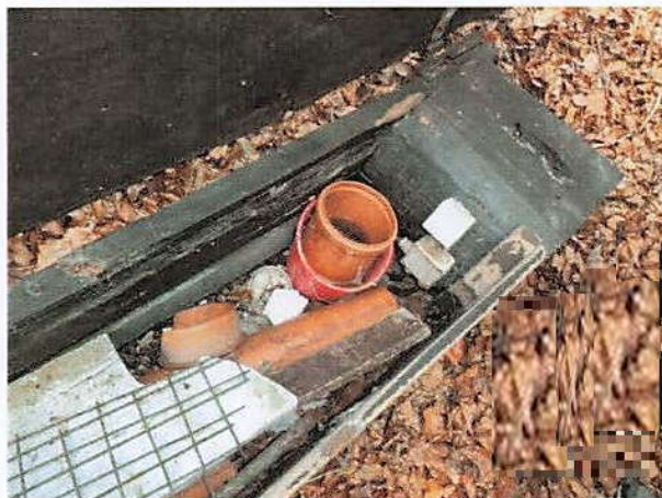
Verteilung in Holzkasten (ehem. Futterbox)
