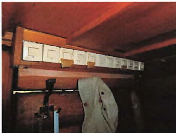
Schalter der Laternen auf dem Grundstück innerhalb der Hütte
