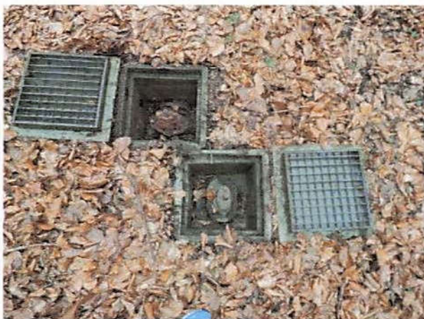
Schächte mit Absperrventilen (ohne Handgriffe/Handrad)
