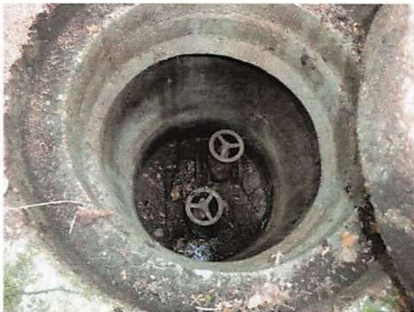
Schacht mit Absperrventilen
