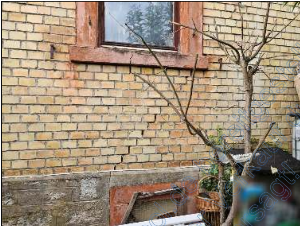
Fassade mit Setz- bzw. Abscherrissen
