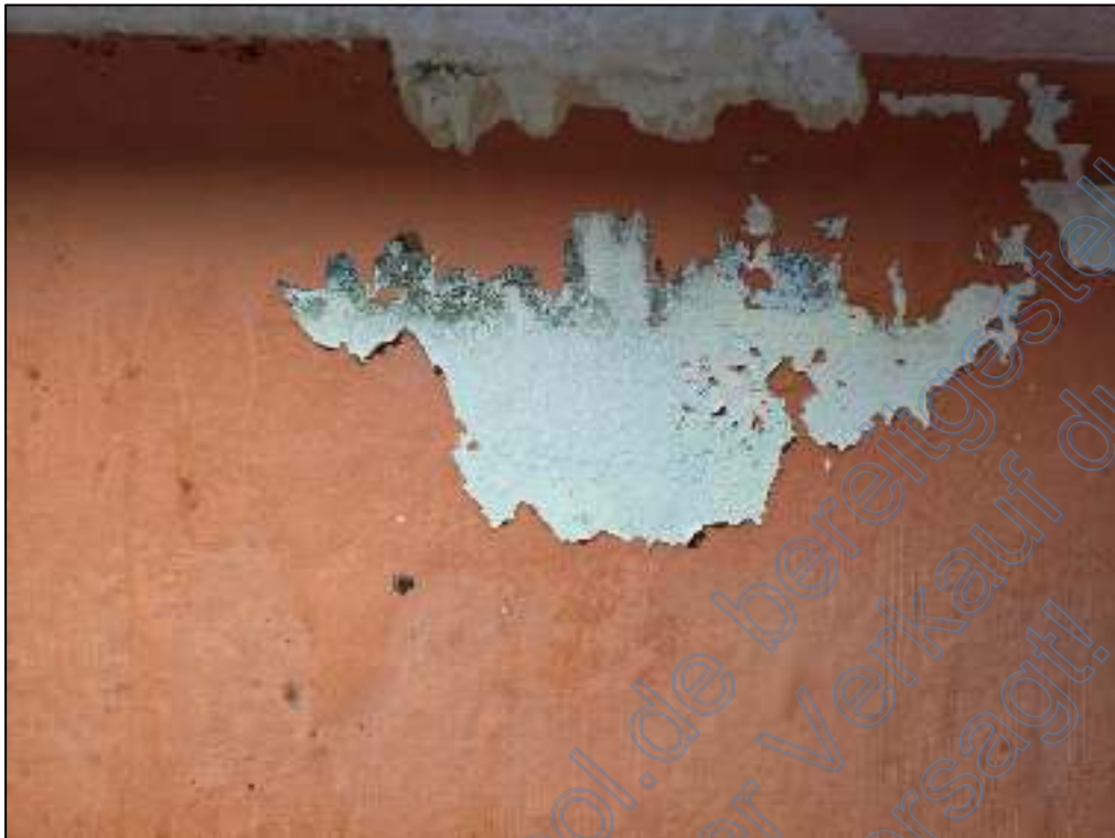
Dachschräge DG mit Schimmelbildung
