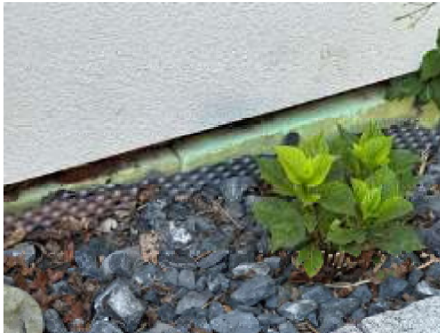
21 Detail Gebäudesockel an der Nordwestseite des Hauses. Die Ausführung des Gebäudesockels erscheint fehlerhaft.
