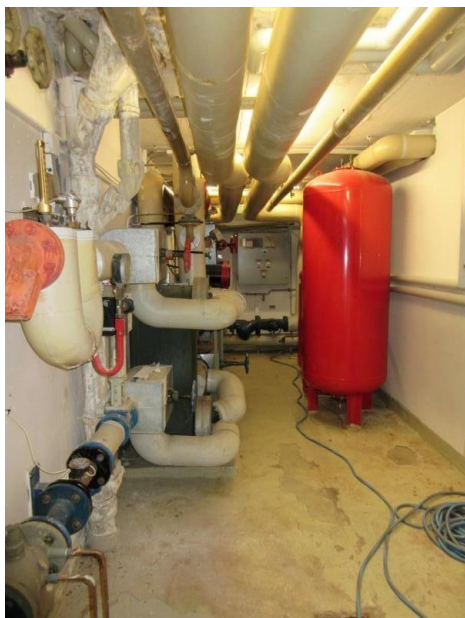
Haustechnik im Untergeschoss
