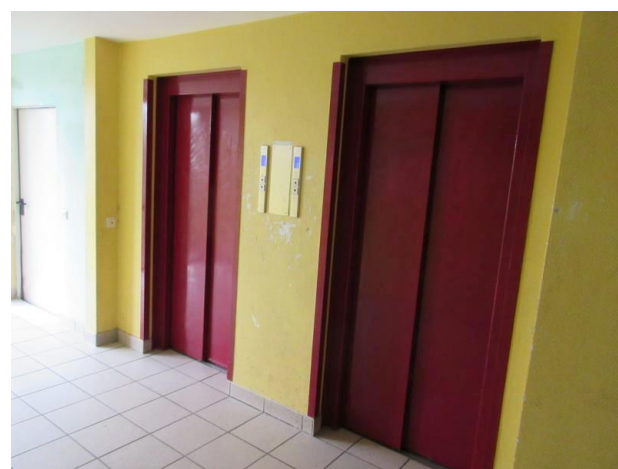
Aufzugsanlagen Otto-Hahn-Platz 1, 12. Obergeschoss
