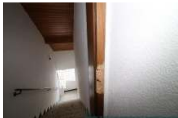
Beschädigter Türrahmen wg. Gewaltamen Aufbrechen am Ortstermin
