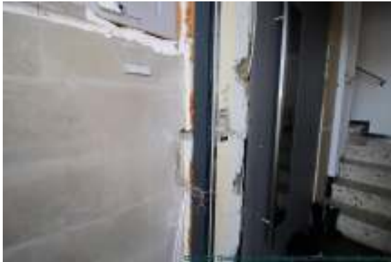
Putzschäden an Umfassungswände
