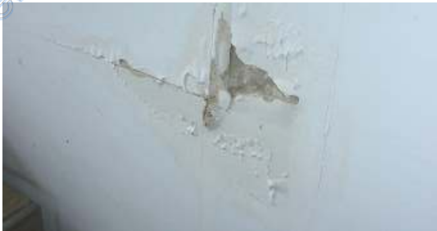
Anstrichschaden im Treppenhaus
