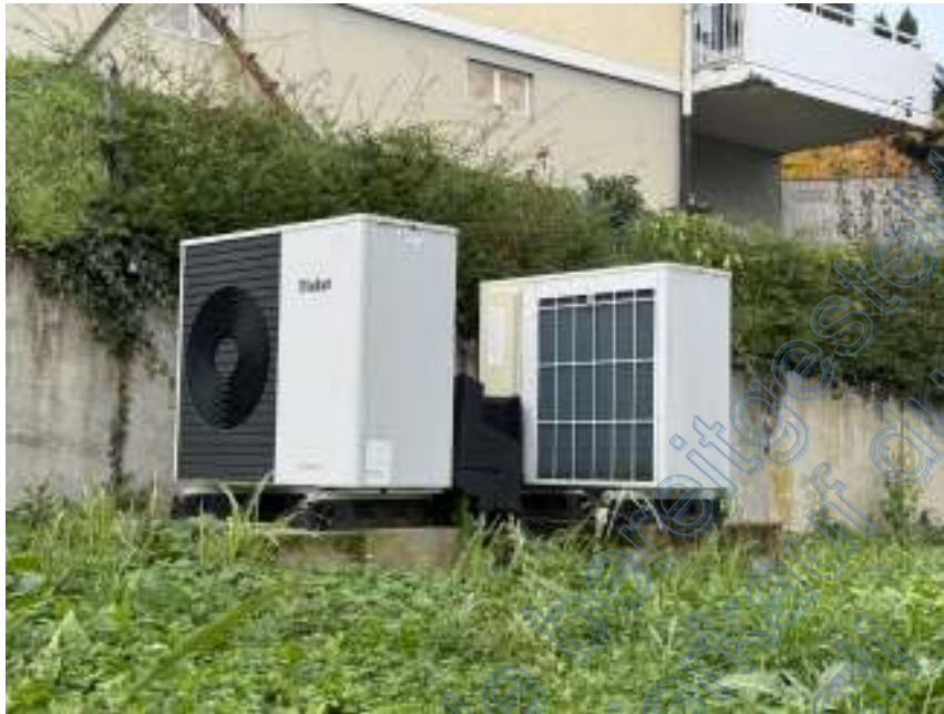
Bild 9: Wärmepumpe an der westlichen Grundstücksgrenze
