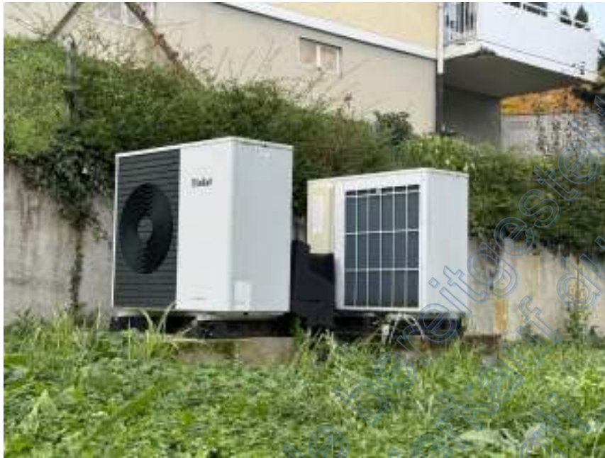
Bild 15: Wärmepumpe an der westlichen Grundstücksgrenze
