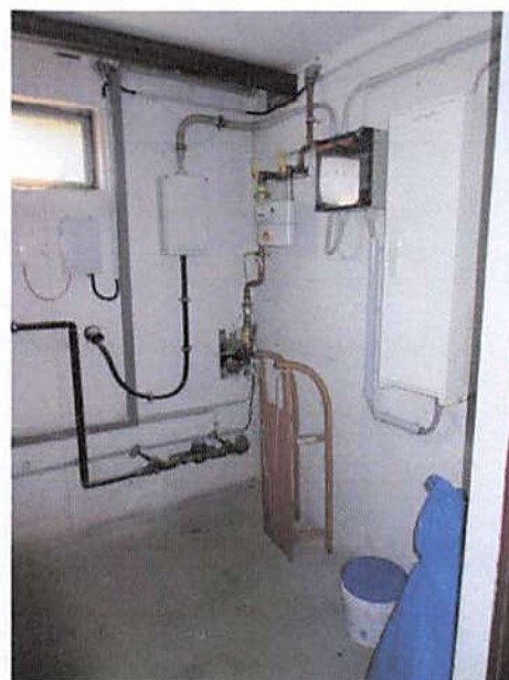
Haustechnik im Keller
