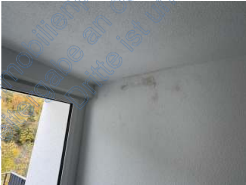
Bild 6: Feuchteschäden an der Wohnzimmerwand nach Südwesten
