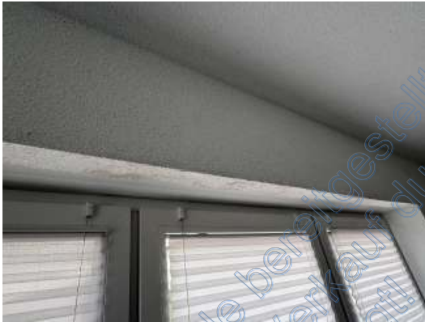
Bild 7: Feuchteschäden im Wohnzimmer im Fensterbereich nach Südwesten
