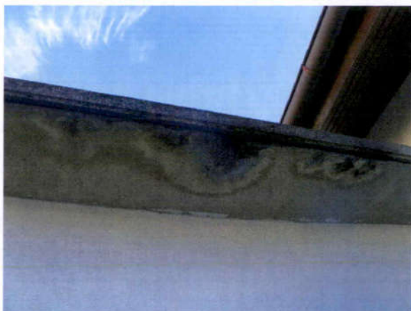
Einzelgarage, Feuchtigkeitsschäden am Dach
