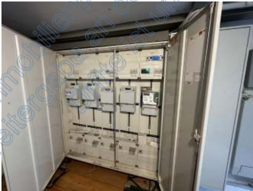
Bild 18: Zählerschrank im Kellergeschoss
