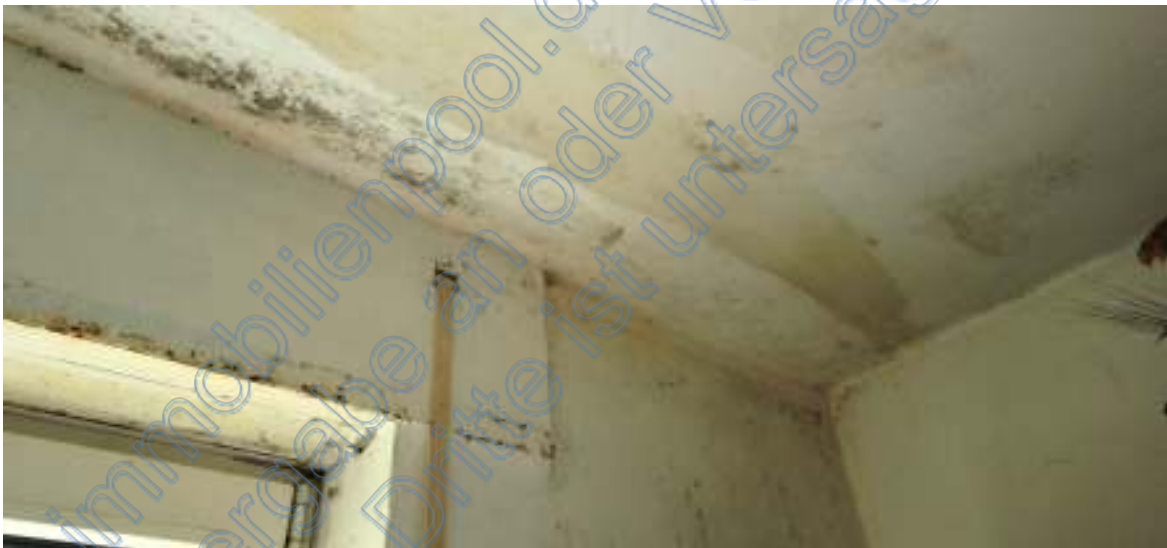
Schimmelflecken in der Küche
