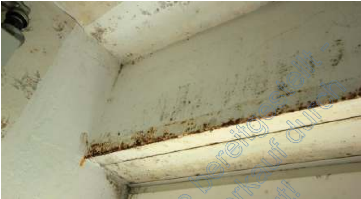
Schimmelflecken in der Küche
