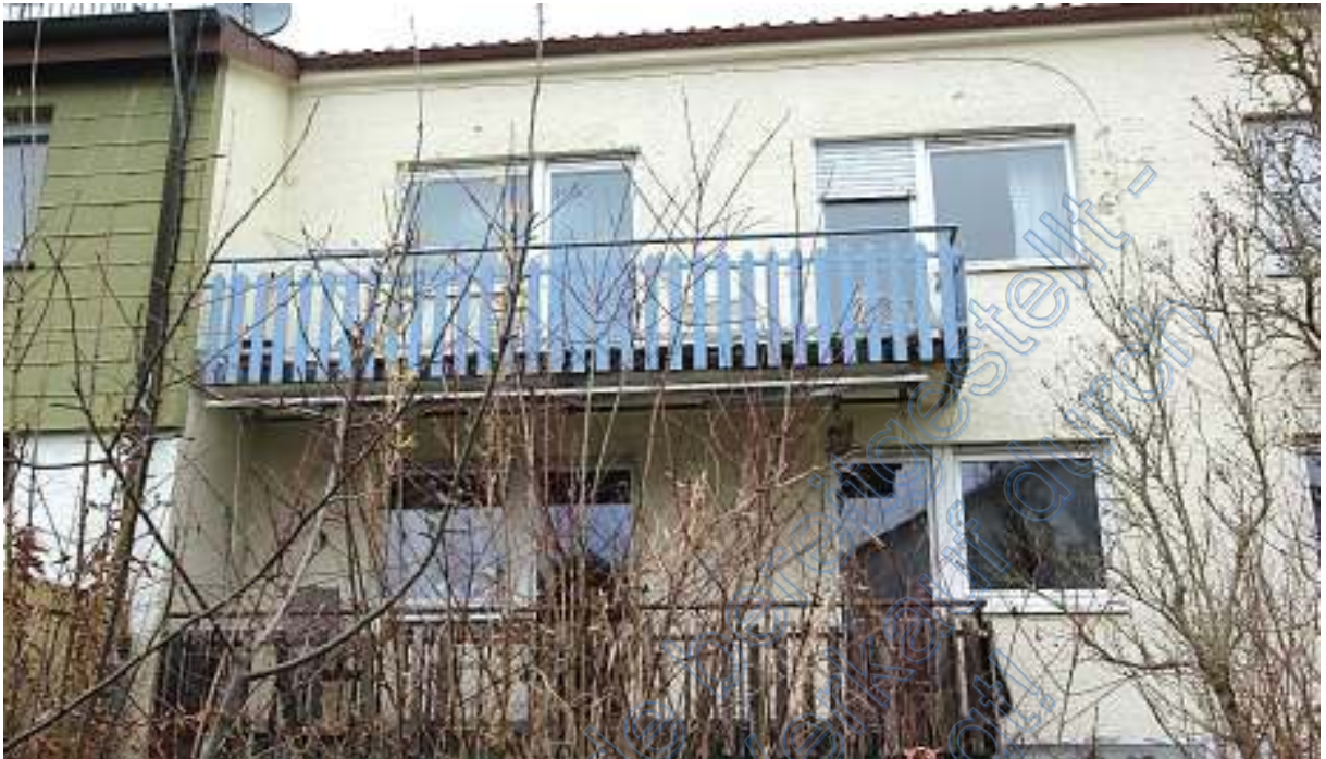
Südfassade Wohnhaus mit alten Balkongeländern
