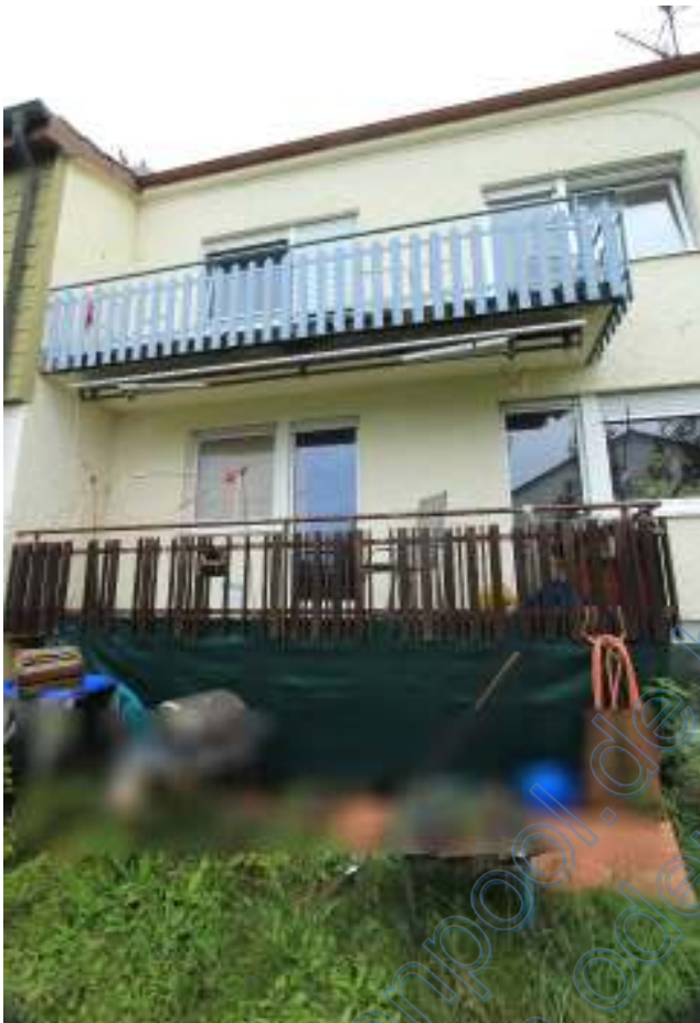
Balkone mit Schäden im Süden
