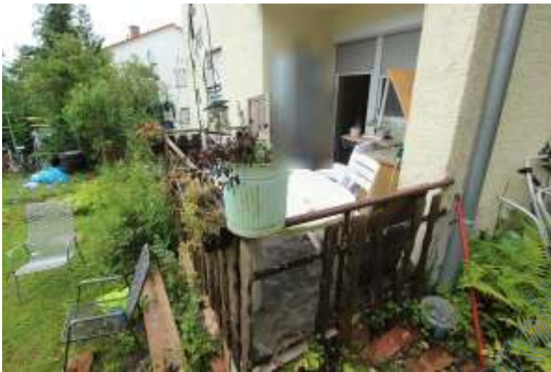
EG-Balkon mit Geländer Schäden
