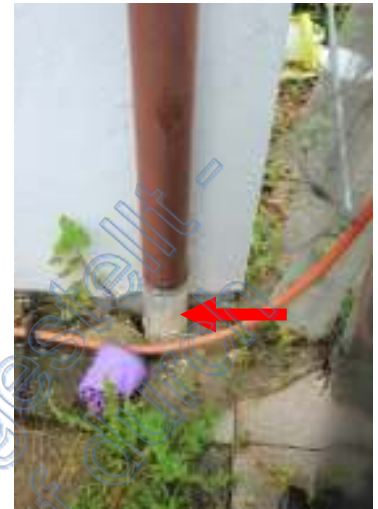
Schaden am Fallrohr
